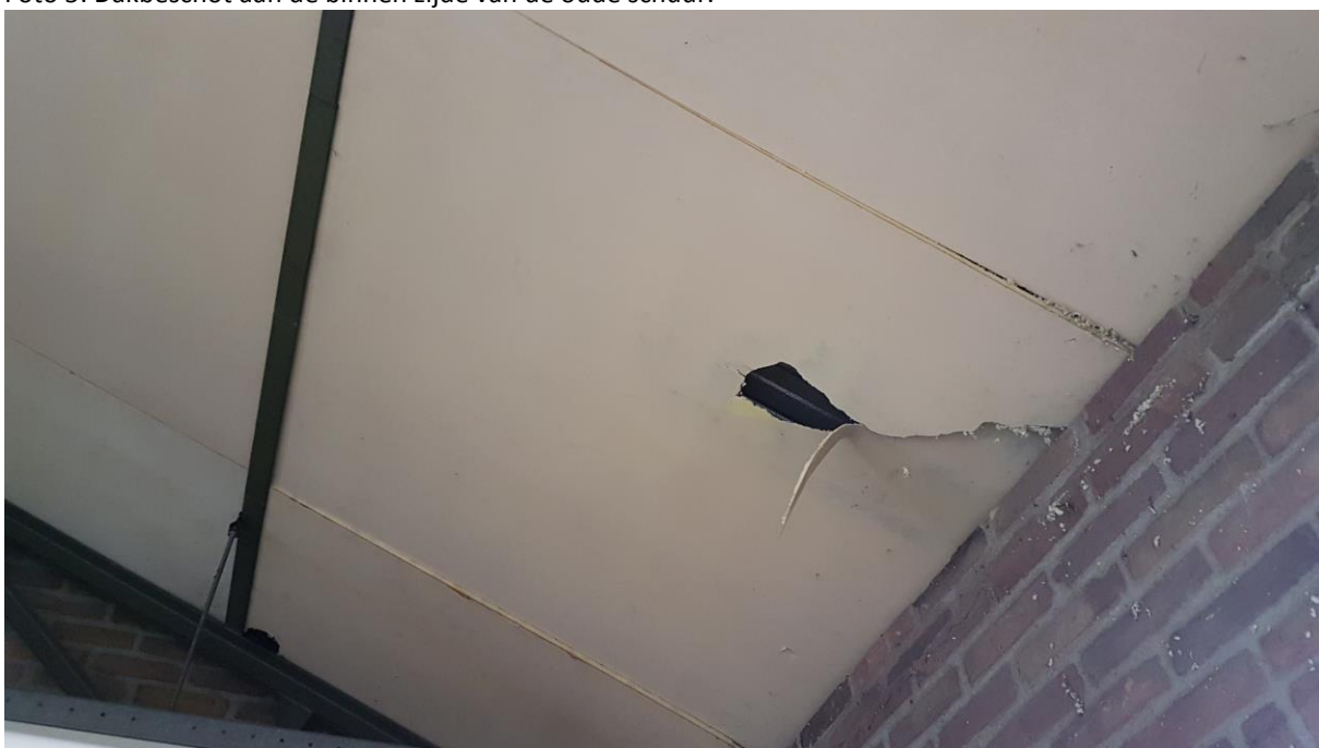
Foto 6: een gat in het dakbeschot waardoor heen de metalen dak te zien is.
