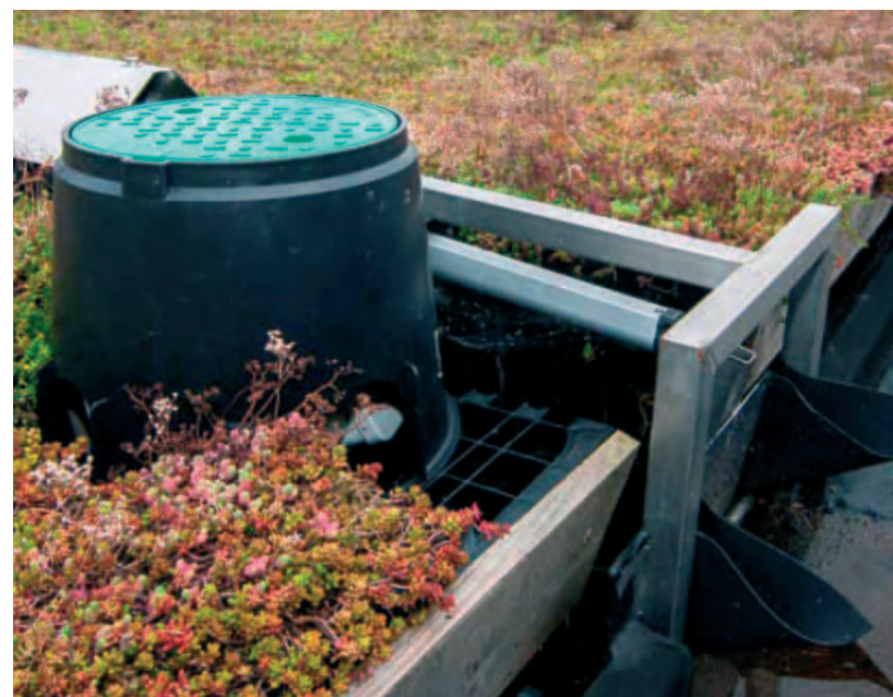
Polderdak met automatisch regelsysteem
