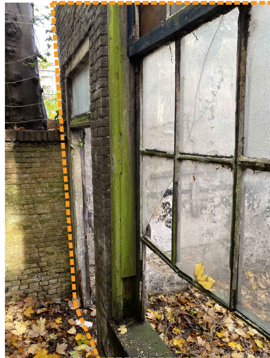
Buitenzijde voorgevel in slechte staat
