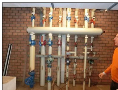
Ongeïsoleerde pompen en afsluiters
