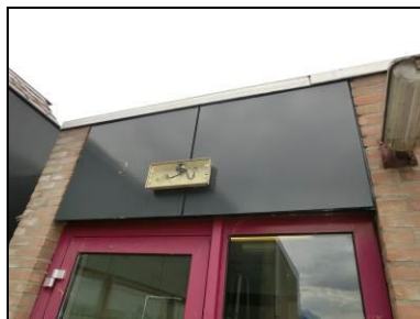
Ontbrekend c.q. defect vluchtweg armatuur
