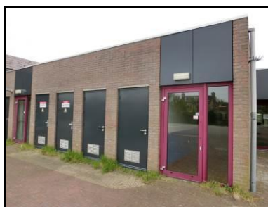
Deuren zuuropslag ruimten, linker vluchtdeur klemt
