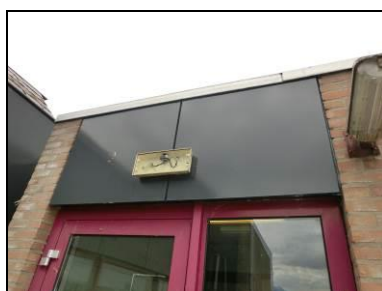
Defect armatuur zwembad
