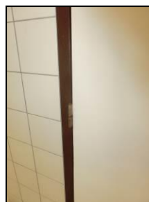
Corroderend hang- en sluitwerk
