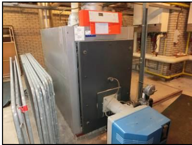
CV-installatie met voorzetbrander
