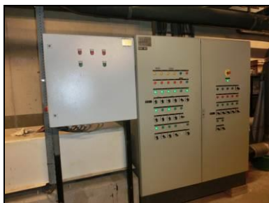
RK WZ1 t.p.v. filtrerruimte zwembad
