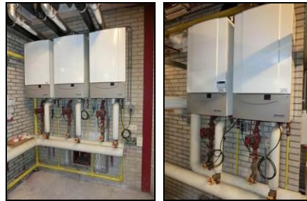
CV-installatie in cascade opstelling
