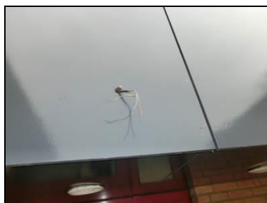
Losse bekabeling buiten
