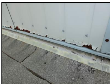
Corrosie onderlangs stalen beplating
