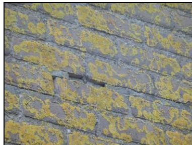
Ontbrekend voegwerk en algengroei
