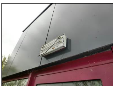
Defect armatuur zwembad
