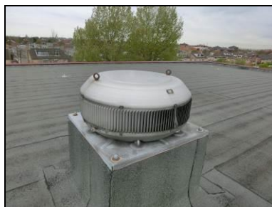
Oudere afzuigventilator op hoge dak
