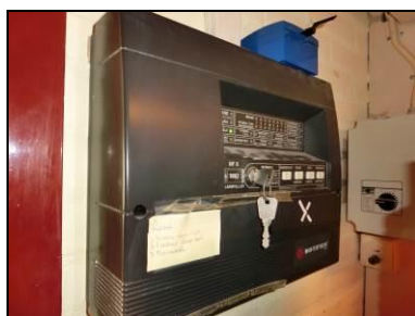
Ontruimingscentrale t.p.v. receptie
