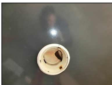
Defect armatuur onder luifel buiten
