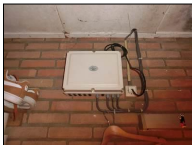
Rada-systeem t.b.v. autom. spoeling
