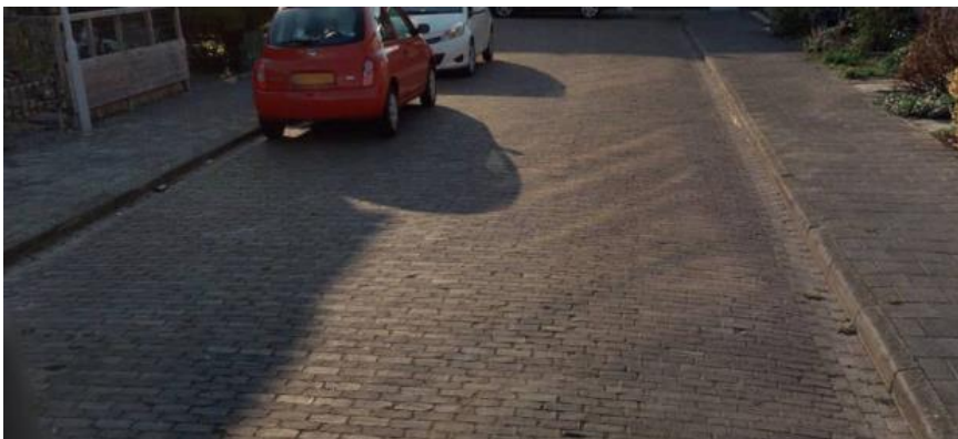
Figuur 11 Voorbeeld verouderde elementenverharding in te lichte constructie
