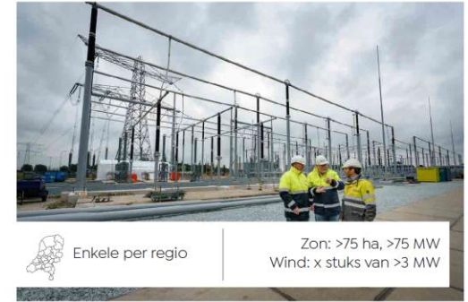
HS-TS station (van 110-150 naar 25-66 kV)
