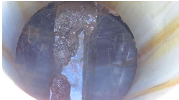
8 Zand in hemelwaterverzamelput
