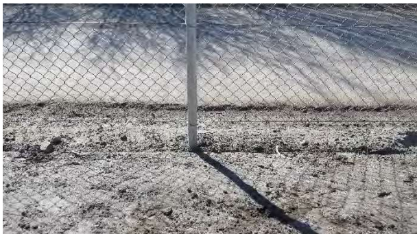
33 Hekwerk (niet tot aan grond)
