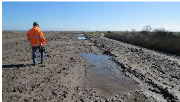
2 Deklaag met natte plekken en dijkje bovensvlak depot
