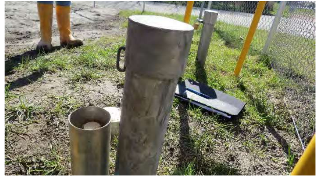
28 Peilbuizen tpv M3.1, 3.2, 3.3 en 3.4 met beschadigde beschermkoker
