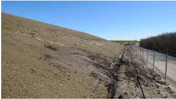
5 Herstelde locatie na verzakking in deklaag aan de zuidkant van het depot
