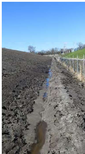
4 Deklaag met natte plekken onderzijde noordkant depot
