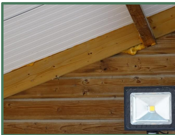
Bouwschuim direct onder de overstekbetimmering
