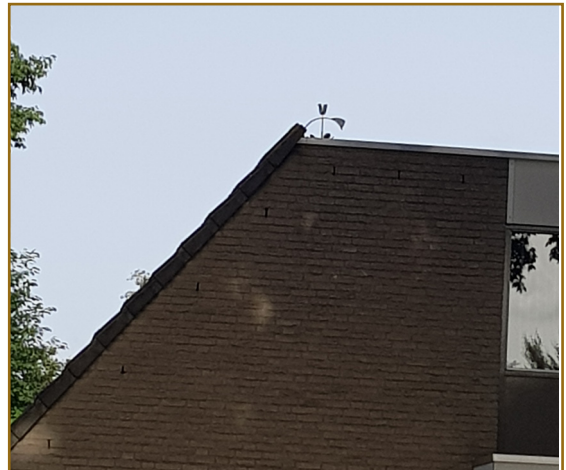
Afbeelding 2.4: Een gevel nabij het plangebied met daarin open stootvoegen welke mogelijk toegang bieden tot een verblijfplaats van vleermuizen.
