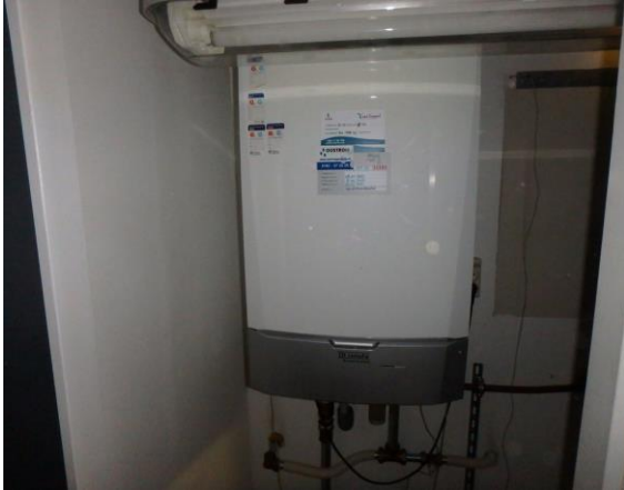
cv-ketels niet verdacht
