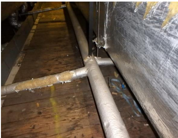
overzicht beperking opnieuw geïsoleerde oude cv-leiding
