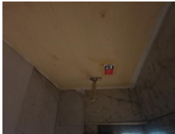
beperking achter veiligstelling schoorsteen trouwzaal
