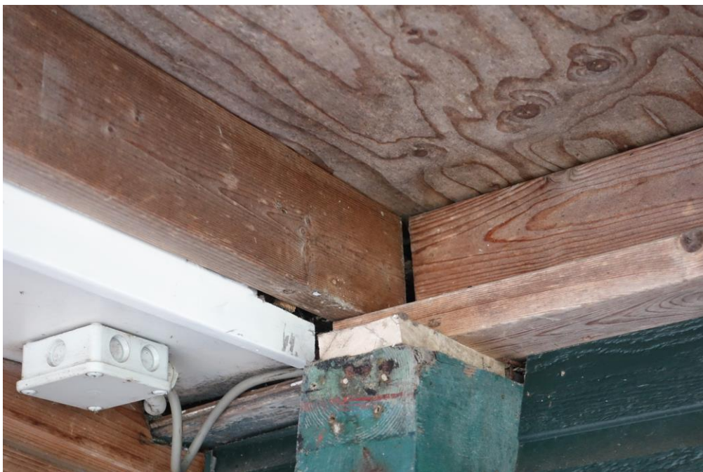
Figuur 7. Blik op overkapte dakconstructie. Hier en daar zitten kieren met enige ruimte achter beschot. Foto Johan Krol. 7-1-2021.
