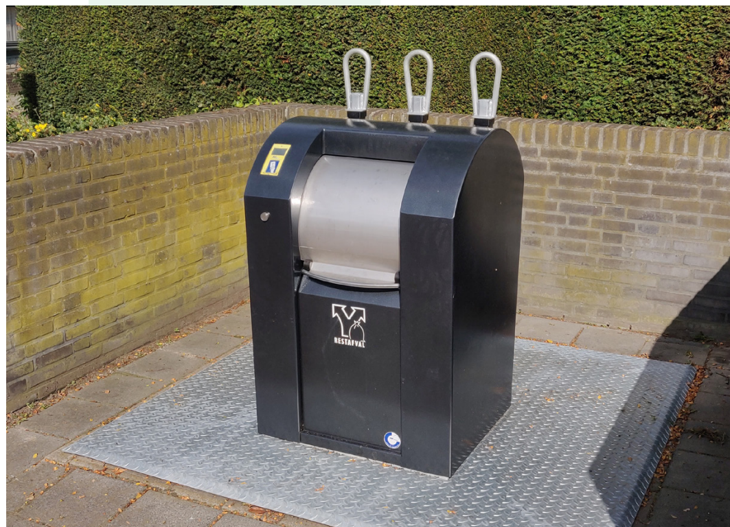
Afvalperron (ondergrondse restafvalcontainer met toegangscontrole) in Bunde.
