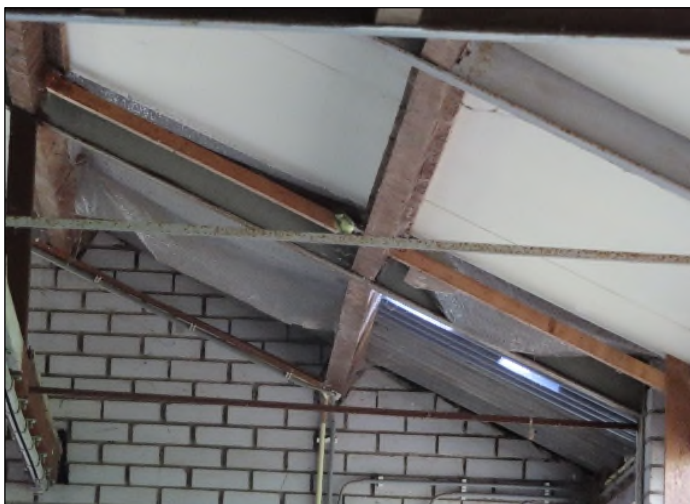
Figuur 4.4 Loszittende plafondplaten in schuur welke potentieel geschikt kunnen zijn als verblijfplaatsen voor gebouwbewonende vleermuizen. Deze schuur blijft echter intact na de herinrichting.
