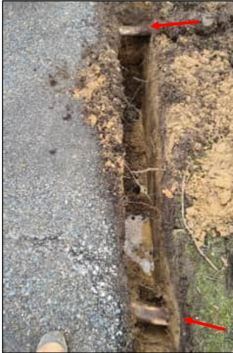
Afbeelding 15: Twee wortels groeien tussen het asfalt en de fundering (rode pijl)
