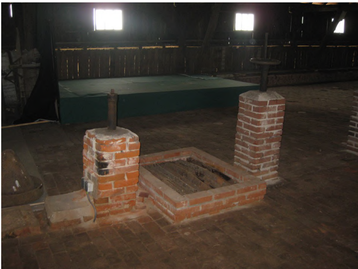
Stookvloer toegang rookkanaal en poeren met de bediening van de luchttoevoer van de oven.
