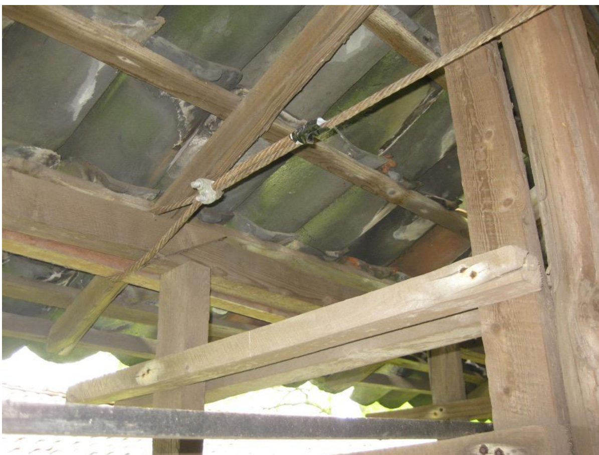
Droogloods 4 staalkabel tegen het spatten van de kap
