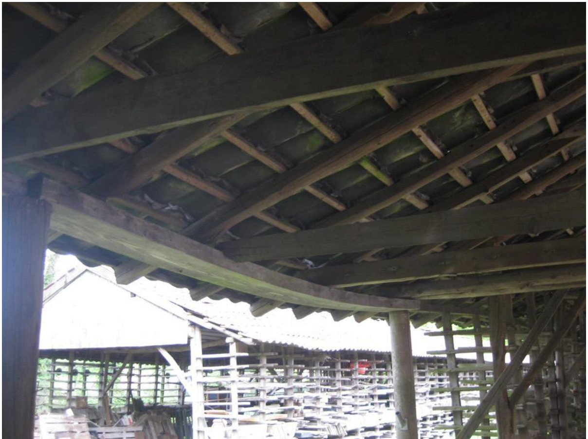
Droogloods 4 doorhangende spantplaat
