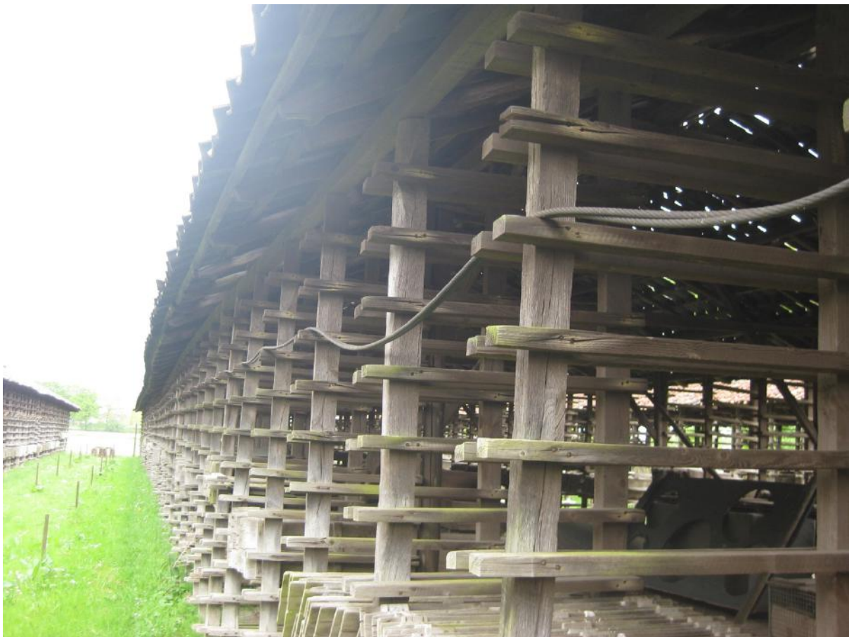
Kabels op de droogrekken van droogloods 7
