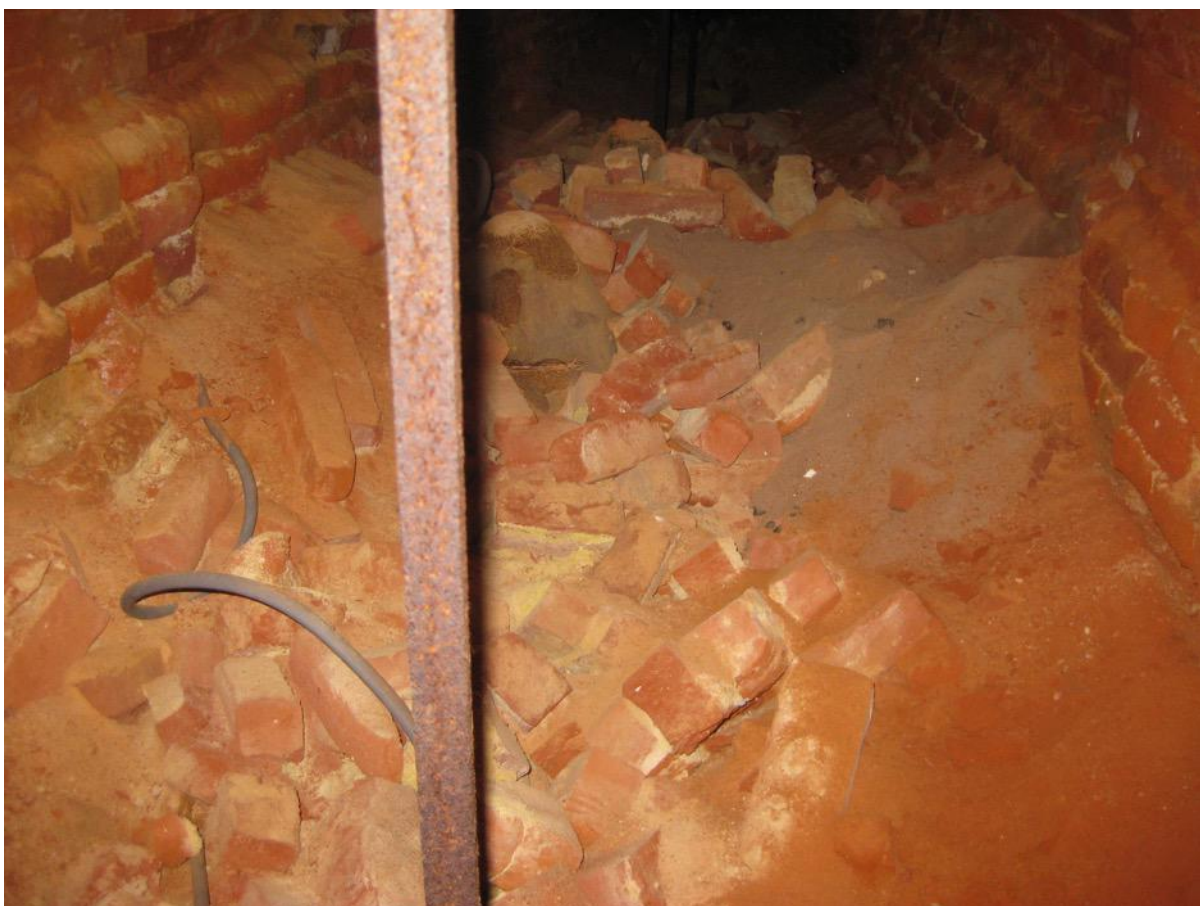
Rookkanaal onder de stookvloer, losgekomen en verpulverde baksteen
