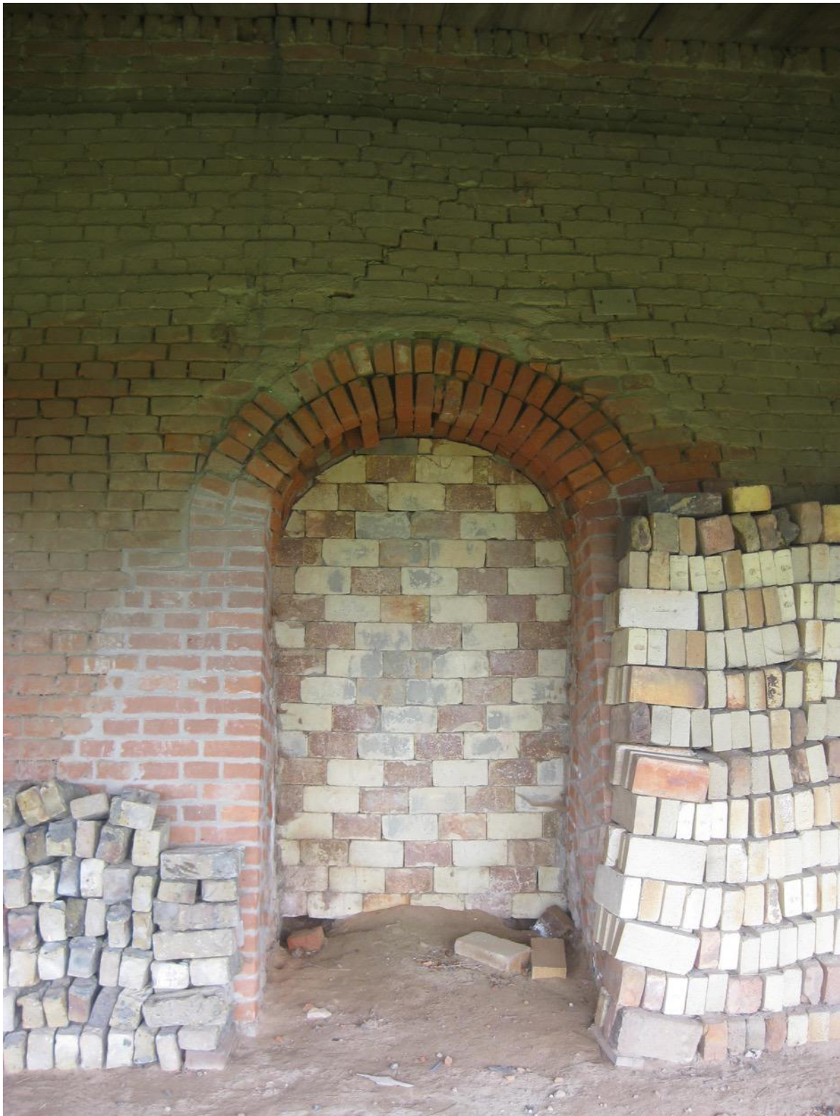
inkruipoort ringoven, voegwerk in de rondboog is verpulverd waardoor de stenen los komen.
