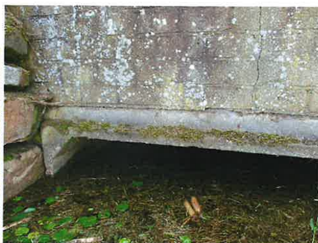
Foto 10: scheur frontwand noordzijde
