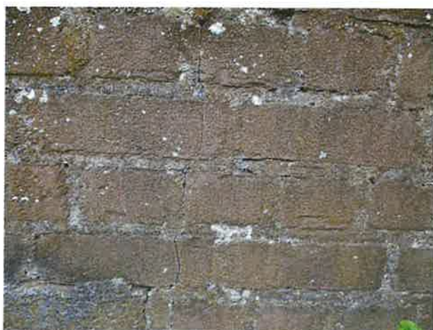
Foto 13: scheur in frontwand zuid
