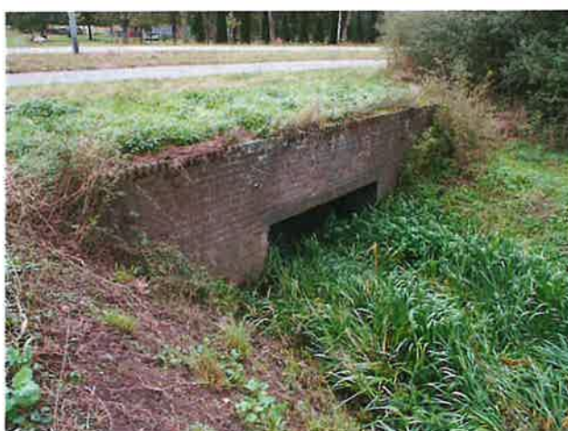
Foto 9: vervuiling/grondophoping frontwand zuid
