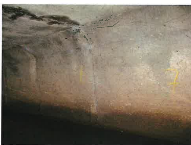
Foto 16: waterinfiltratie door voegen
