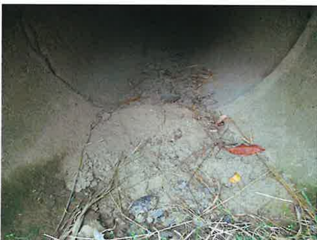
Foto 11: aanzicht zanduitspoeling door kanteling buiselement
