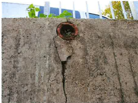
Foto 8. Aanzicht doorgaande scheur (sectie 1)
