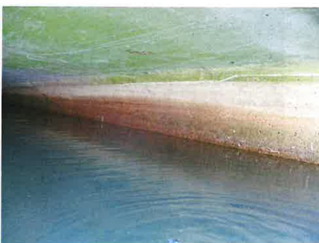
Foto 14: aanzicht erosie binnenzijde koker
