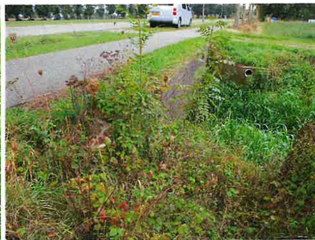
Foto 12: vervuiling/grondophoping frontwand noord
