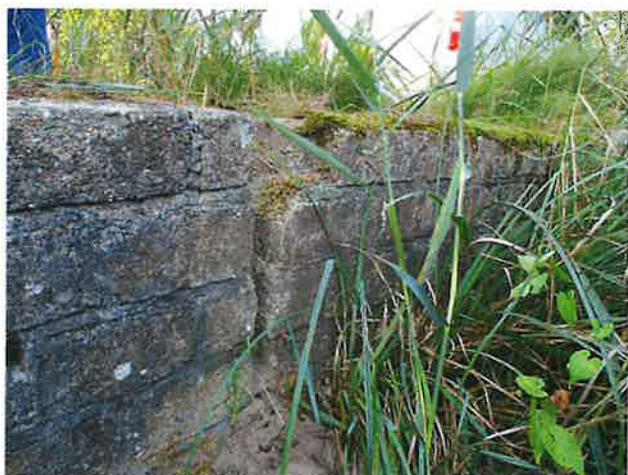
Foto 11: scheur en verzakking frontwand oost
