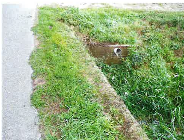
Foto 11: vervuiling/grondophoping frontwand noord
