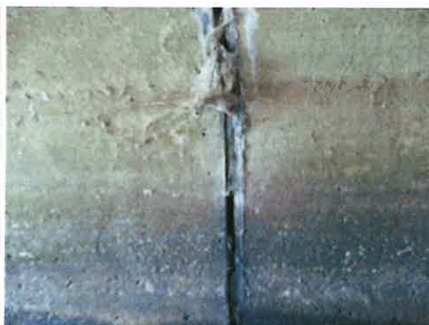
Foto 12: aanzicht openstaande voegen
