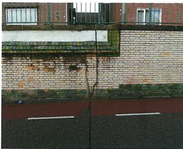
Foto 8: aanzicht openstaande dilatatievoeg
