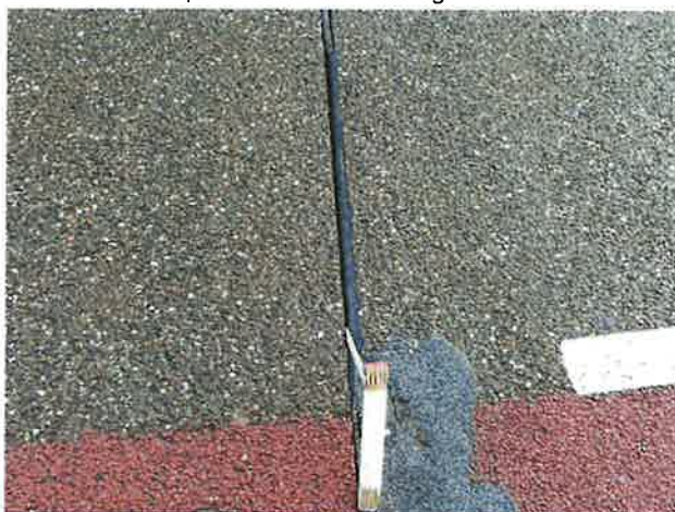
Foto 9: aanzicht openstaande dilatatievoeg
