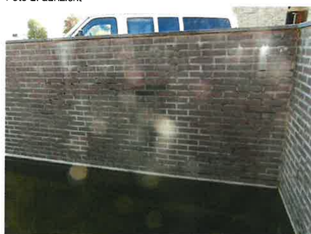
Foto 4: aanzicht vervuiling metselwerk
