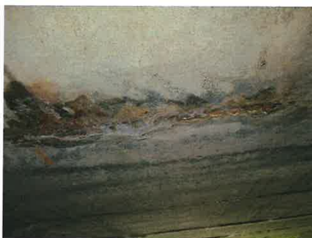
Foto 15: waterinfiltratie door voegen
