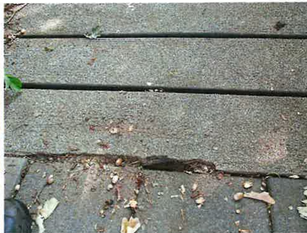
Foto 6: aanzicht defecte plank
