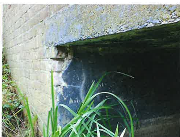
Foto 18: defecte raaplaag metselwerk landhoofd deel
