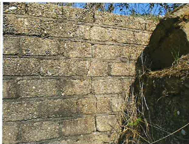
Foto 8: scheur frontwand zuirdzijde
