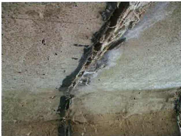
Foto 13: aanzicht openstaande voegen
