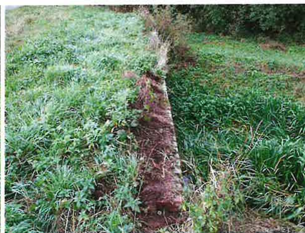
Foto 10: vervuiling/grondophoping frontwand zuid
