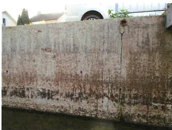
Foto 9. Aanzicht doorgaande scheur (sectie 1)
