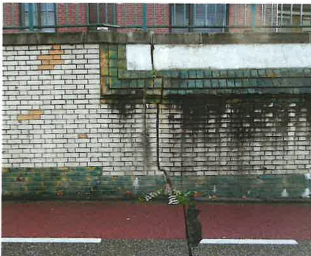
Foto 7: aanzicht openstaande dilatatievoeg
