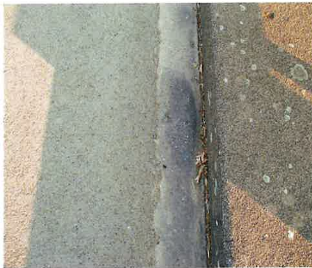
Foto 6: aanzicht gietasfaltgoot met blaasvorming
