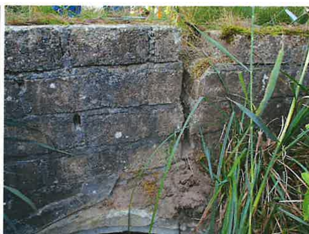
Foto 10: scheur en verzakking frontwand oost
