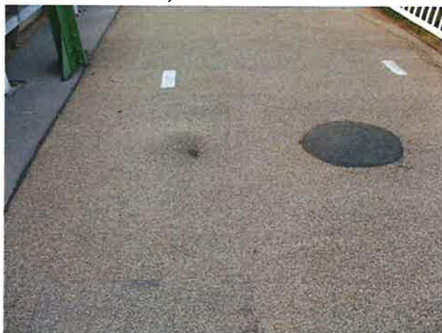
Foto 3: aanzicht blaasvorming gietasfalt
