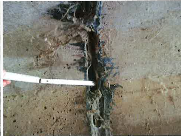
Foto 14: aanzicht openstaande voegen
