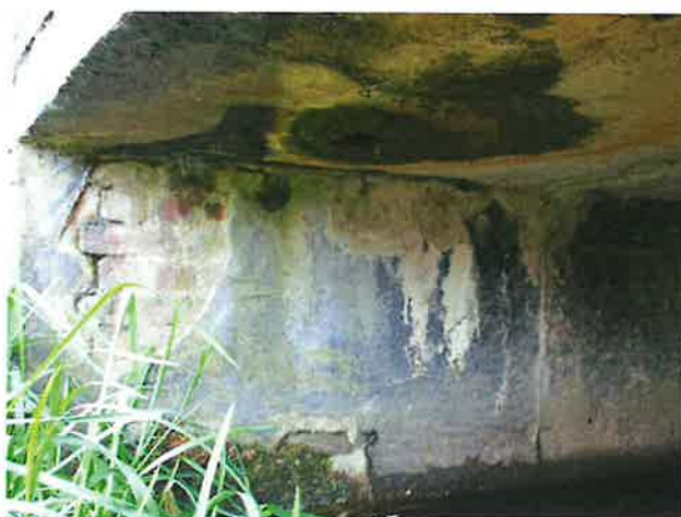
Foto 17: defecte raaplaag metselwerk landhoofd deel
