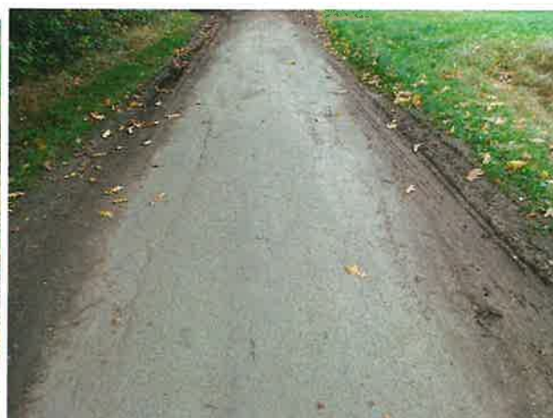
Foto 8: aanzicht scheurvorming en zink in asfaltverharding
