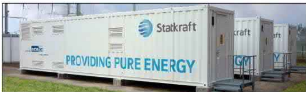
Figuur 6: Energieopslagsysteem gerealiseerd door Statkraft te Dörverden, Duitsland
