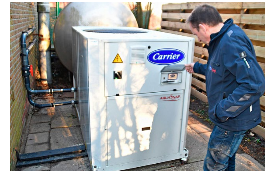
Nog een laatste check voordat de warmtepomp van Zwembad de Zien in werking wordt gesteld (fotografie: Ger Bus)
