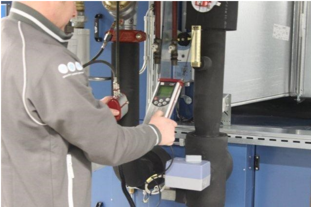
Optimaal inregelen klimaatinstallatie
