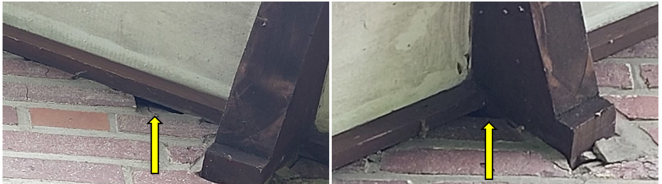
Figuur 4.4.8. Tussen het dakoverstek en de gevels bevinden zich enkele gaten die vleermuizen toegang kunnen verlenen tot de spouw.
