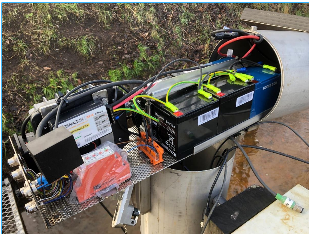
Figuur 2-3: binnenzijde van een van de sensorpalen met daarin de apparatuur en accu's (foto: N. van Aarle, Aquon)
