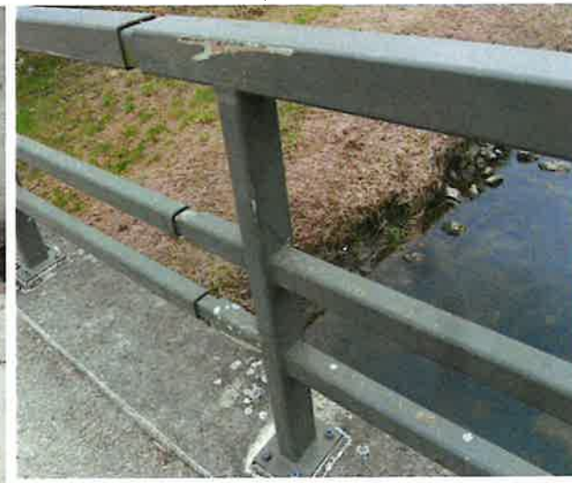
Foto 6: conservering leuning beschadigd
