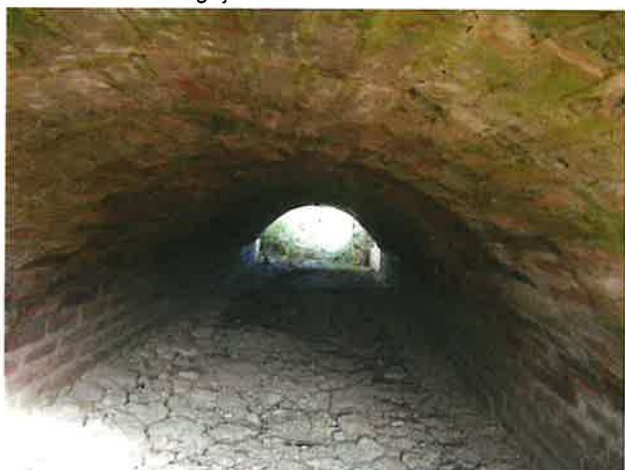
Foto 3: aanzicht duiker inwendig
