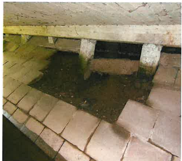
Foto 10: aanzicht talud uitspoeling noordelijk landhoofd
