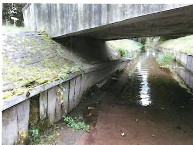
Foto 8: aanzicht defect talud en beschoeiing
