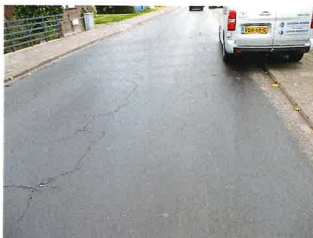
Foto 8: aanzicht scheurvorming asfaltverharding
