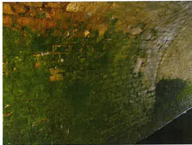
Foto 8: aanzicht mosafzetting metselwerk
