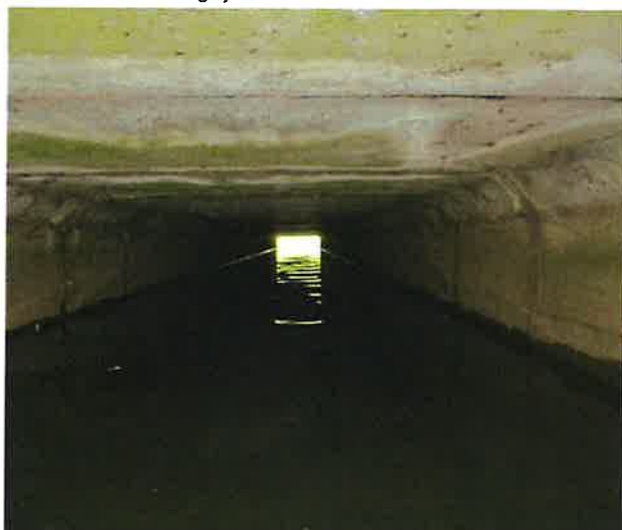
Foto 3: aanzicht duiker inwendig
