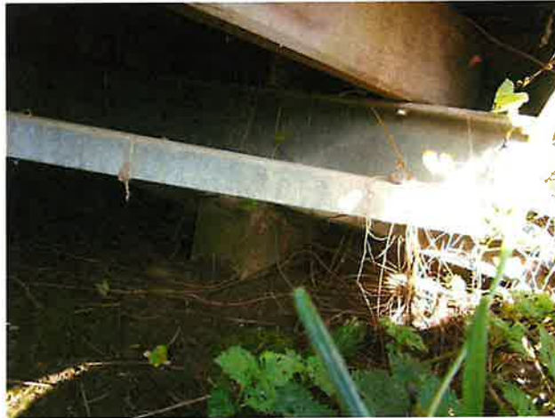
Foto 6: aanzicht vervuiling landhoofd
