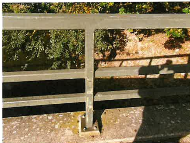
Foto 4: aanzicht beschadiging conservering leuning
