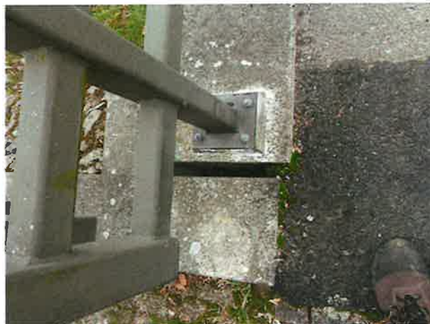
Foto 14: naadloze voegovergang niet waterdicht afgewerkt
