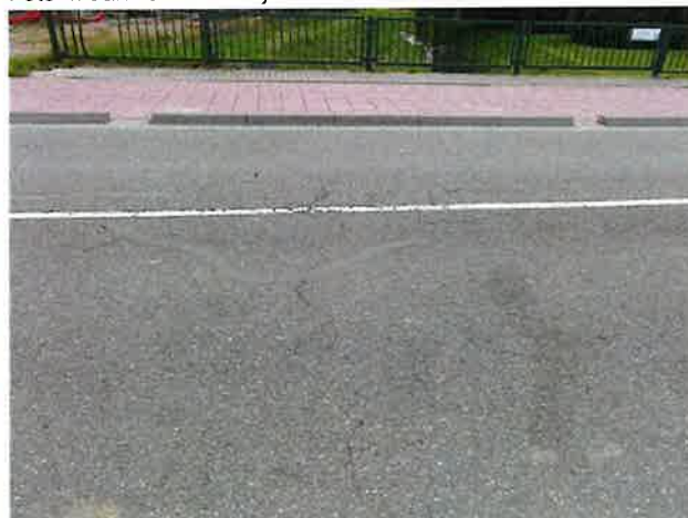
Foto 6: aanzicht gescheurde asfaltverharding
