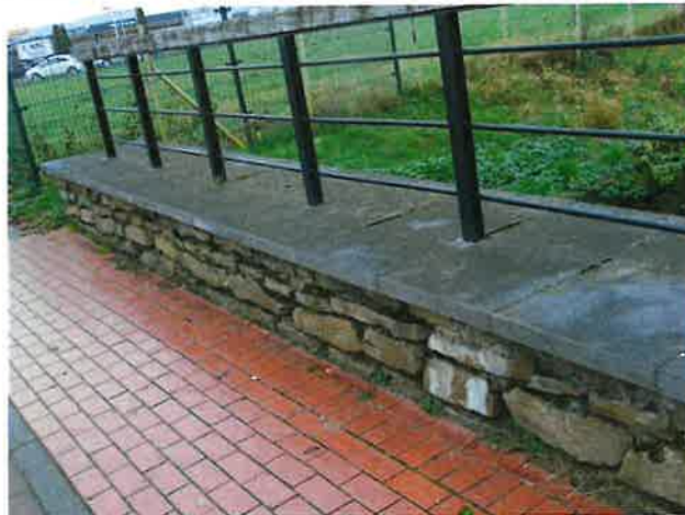
Foto 6: aanzicht mosvorming op voegwerk
