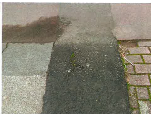
Foto 8: defect in naadloze voegovergang oost
