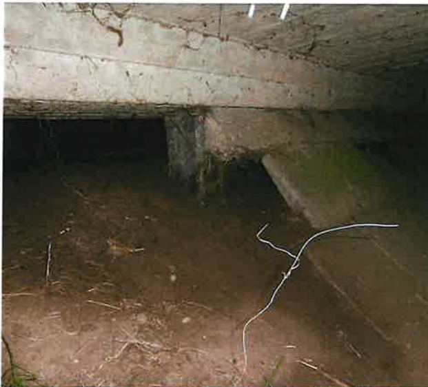
Foto 9: aanzicht talud uitspoeling zuidelijk landhoofd
