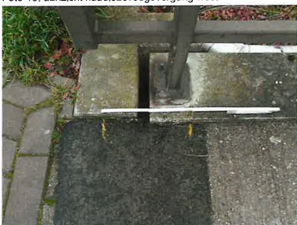
Foto 15: naadloze voegovergang niet waterdicht afgewerkt
