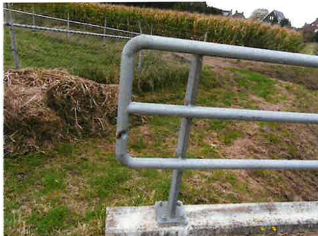
Foto 8: aanzicht schade aan leuning
