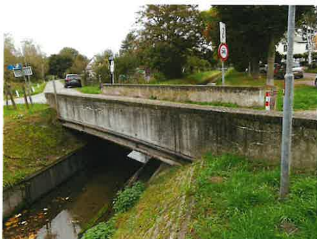
Foto 7: aanzicht defect talud en beschoeiing
