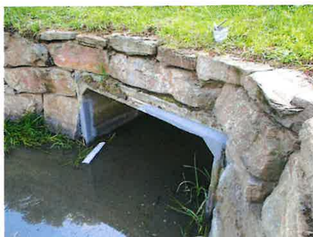
Foto 8: aanzicht herstelde dekkingschade (uitstroomzijde)
