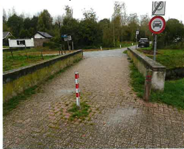
Foto 6: aanzicht defecte beschoeiing
