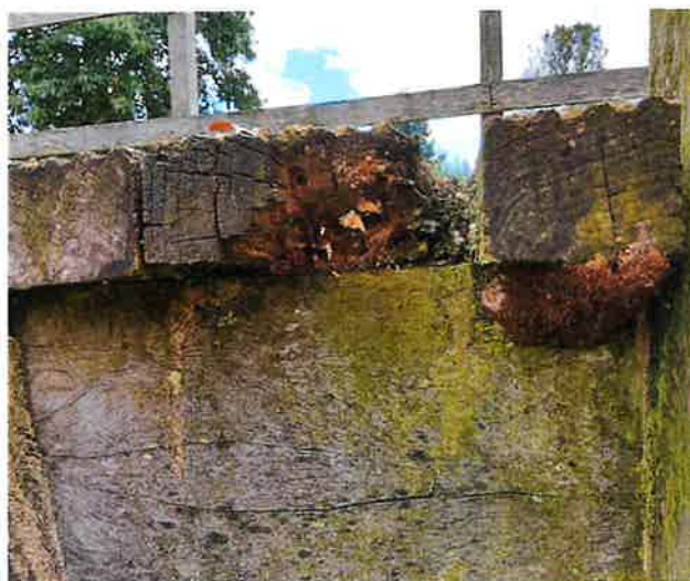
Foto 6: aanzicht defecte planken
