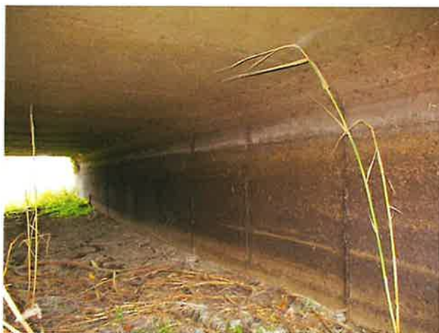
Foto 13: aanzicht erosie beton
