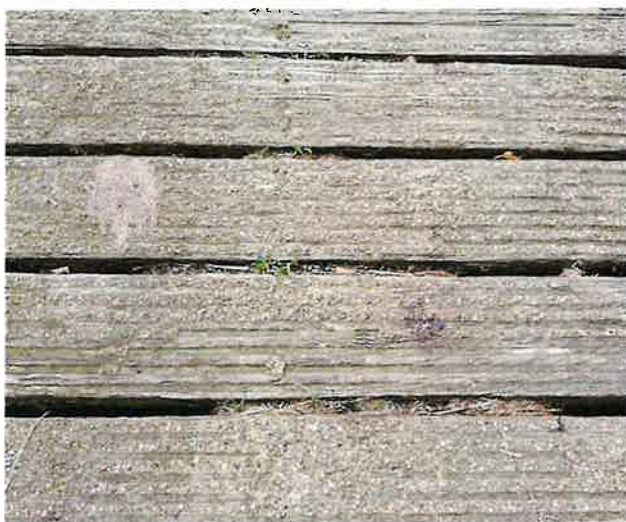
Foto 5: aanzicht vervuiling tussen plankdelen
