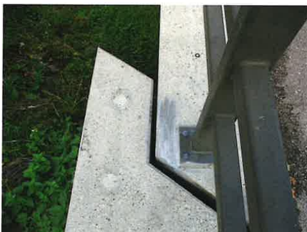
Foto 21: aanzicht openstaande voegovergang schamkant
