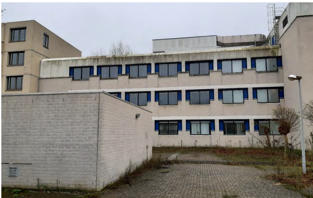
Foto 3: Aan de achterzijde (zijde De Maasvallei) staat een bijgebouw met eveneens open stootvoegen. De bestrating aan deze zijde van het Belastingkantoor is begroeid met ruigtekruiden door het wegvallen van beheer.
