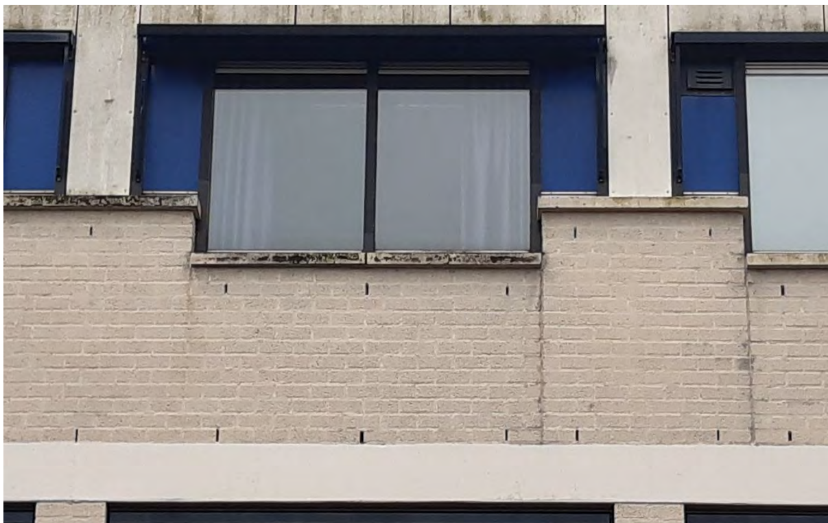
Foto 2: Het voormalige Belastingkantoor bevat vele open stootvoegen aan alle zijden die onder meer vleermuizen toegang kunnen geven tot de spouw. Aan de voorzijde van het Belastingkantoor (zijde Raadhuislaan) waren ongeveer de helft dichtgezet met rasters, maar velen waren beschadigd en stonden open.
