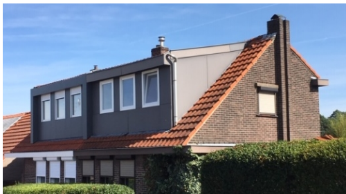
Dakkapel: voldoet niet
