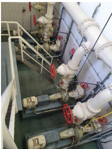
Hoofdrioolgemaal De Lange Hagel
