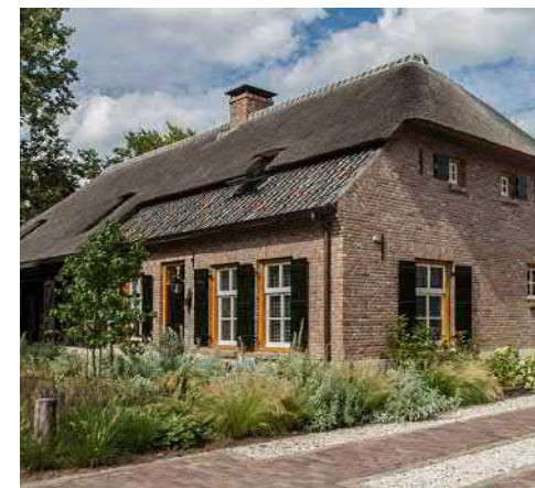
Pannen ter plaatse van het woonhuis
