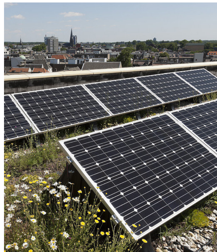
Daklandschap wekt energie op door middel van PV panelen.
