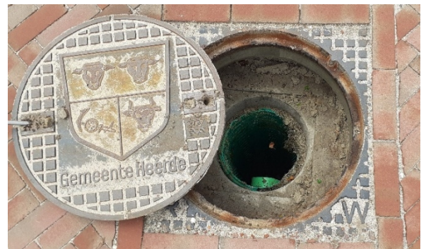
Figuur 3: Voorbeeld infiltratieput in gemeente Heerde
