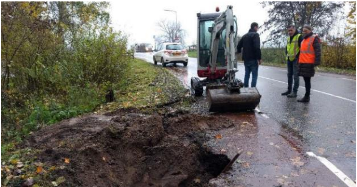
Figuur 3: Schade aan de weg door ingestort bevergat (foto: Aa en Maas)
