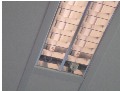
Figuur 7 De verlichting wordt deels geregeld via daglichtregeling.
