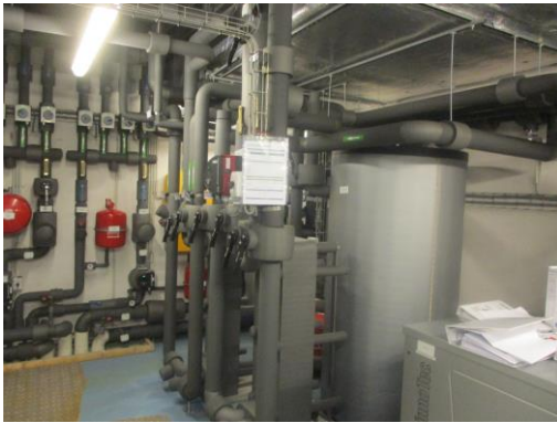
Figuur 4 Het gebouw wordt verwarmd middels een bodemwarmtepomp.
