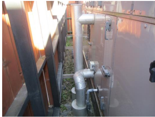
Figuur 5 De aanwezige luchtbehandelingskast met warmteterugwinning.
