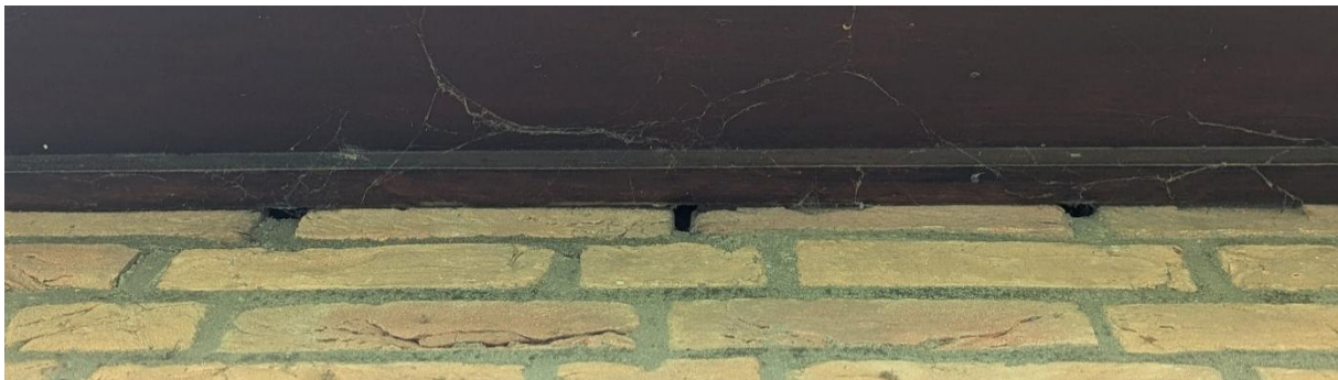
Afbeelding 5: Open stootvoegen onder de dakrand.
