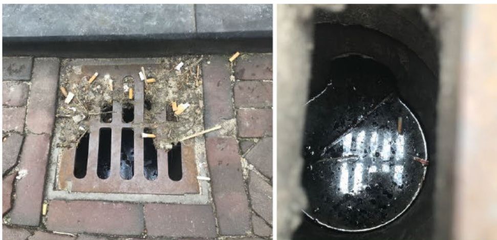
Afbeelding 3.6 Straatkolk, buiten- en binnenzijde
