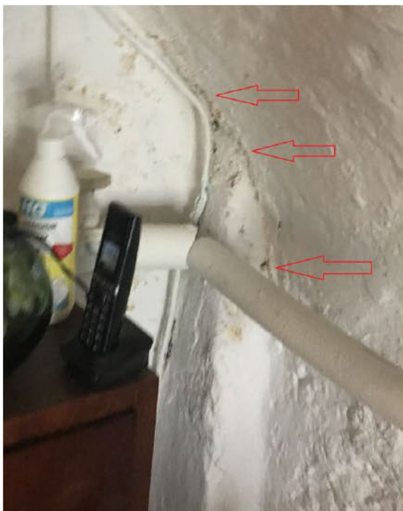
Afbeelding 2.3 Vochtproblemen bij aansluiting kelder op straatgevel
