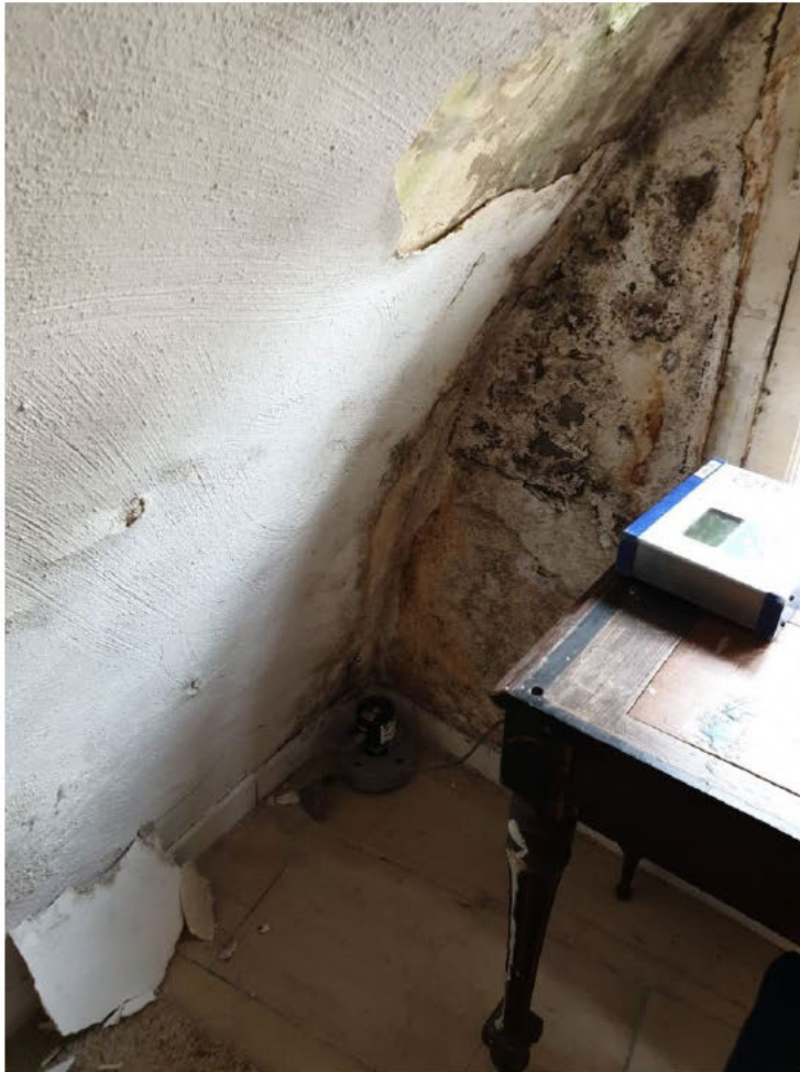
Afbeelding 2.2 Vochtproblemen aan voorzijde vanaf aansluiting boog op geboorte
