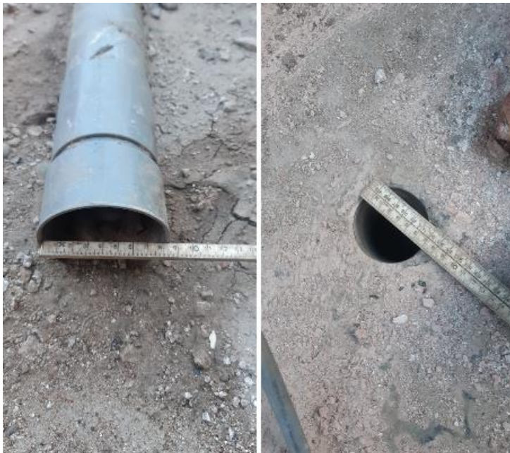
Afbeelding 3.14 Afvoerbuizen in de ondergrond
