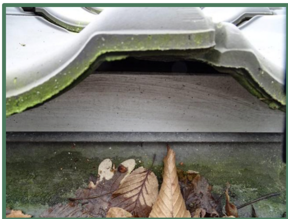
Foto 22: Metalen panlat onder onderste rij dakpannen.
