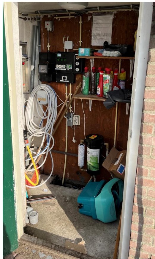
Foto meterkast drinkwater – vóór
