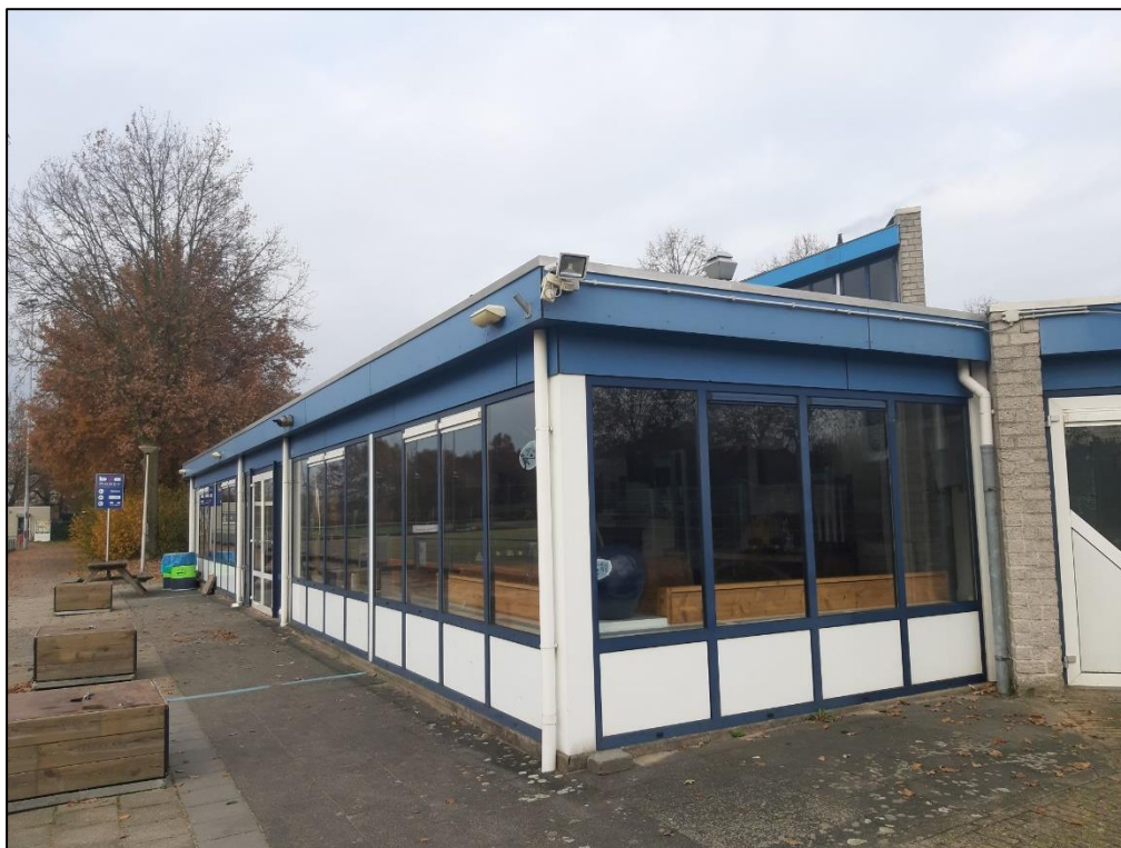
Figuur 5: Het gebouw van de hockeyvereniging. Verblijfplaatsen van vleermuizen zijn hier niet uit te sluiten.
