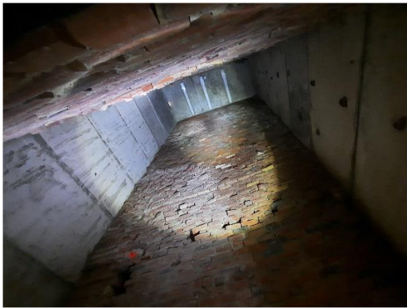
Figuur 5.19. Impressie binnenzijde klimtoren, hoogste deel.
