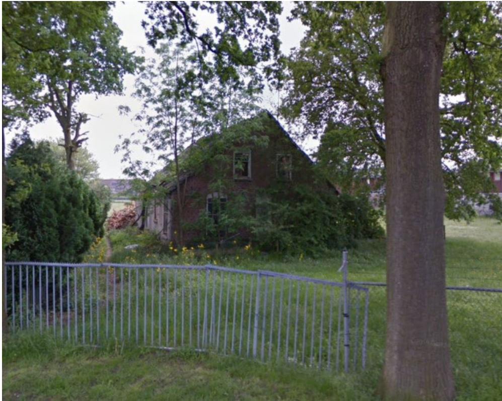
Bestaande vervallen woning Grietakkers 7
