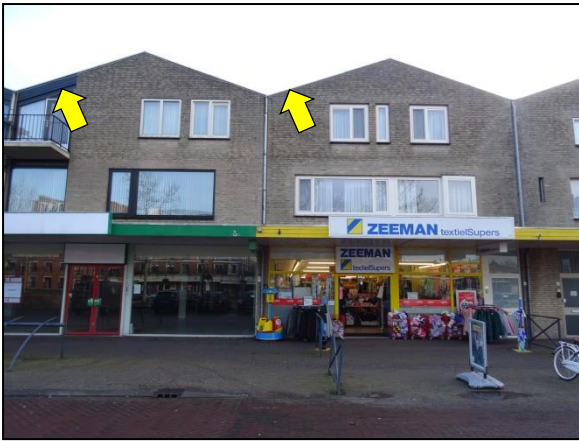
Figuur 11. Potentiele verblijfplaats voor gebouwbewonende vleermuizen in de spouwmuur, achter betimmering en onder de dakrand.
