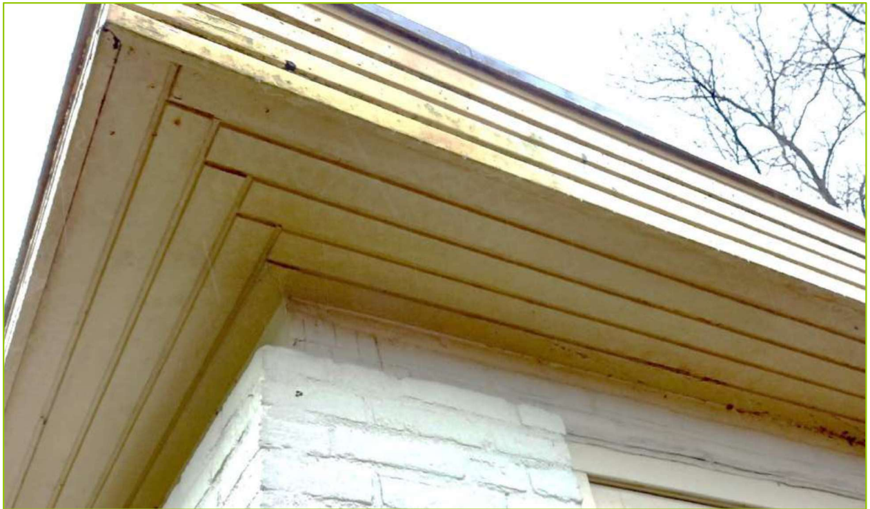
De overstek en daklijst sluiten nauw aan, waardoor er geen openingen zijn met toegang tot eventuele holle ruimtes onder de dakbedekking of in de gevels
