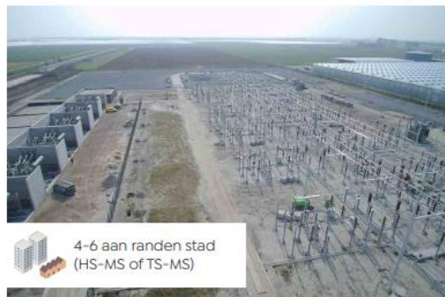
HS-MS station (van 110-150 naar 3-23 kV)
