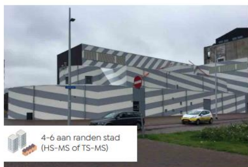
TS-MS station (van 25-66 naar 3-23 kV)
