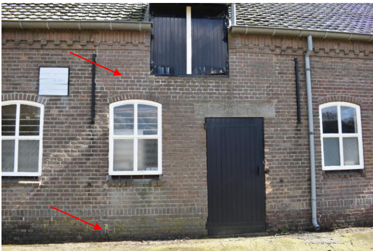
De rode pijl wijst inboetwerk aan en de duim van de voormalige staldeur.
