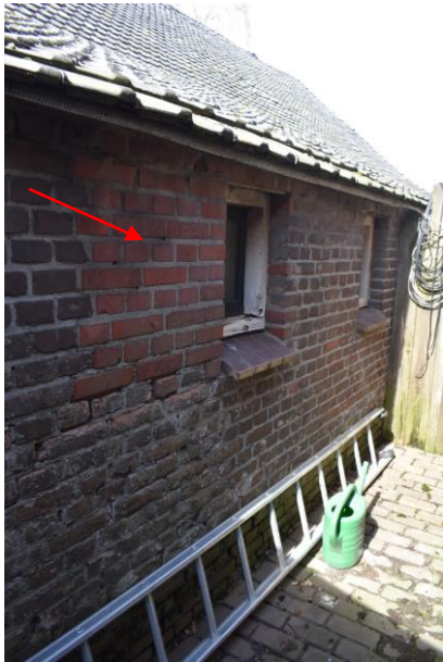
Achterevel bedrijfsdeel met twee houten vensters. De rode pijl wijst inboetwerk aan.
