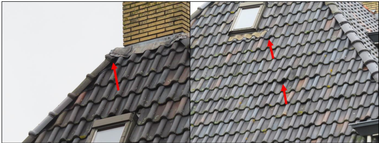
Figuur 2.1. Tussen en onder gegolfde dakpannen zijn voor huismussen geschikte ruimten aangetroffen.
