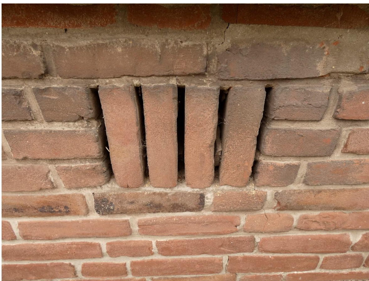
Ventilatieopeningen in de spouwmuur op 50 cm hoogte
