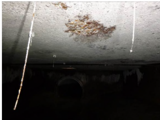
D: Biogene zwavelzuurcorrosie van beton op de dekplaat
