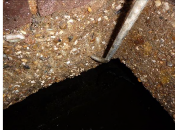
B: Het beton van de dekplaat is zacht en gecorrodeerd
