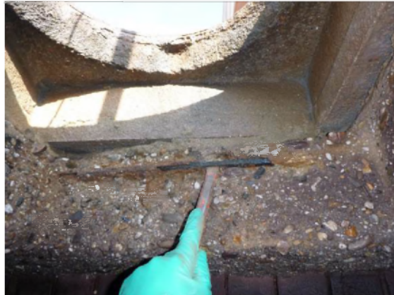
B: Sterk gecorrodeerde dekplaat met uitvallende toeslagstoffen en vrij liggende gecorrodeerde wapening
