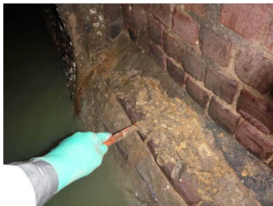
F: Het betonnen banket is gemakkelijk weg te krabben
