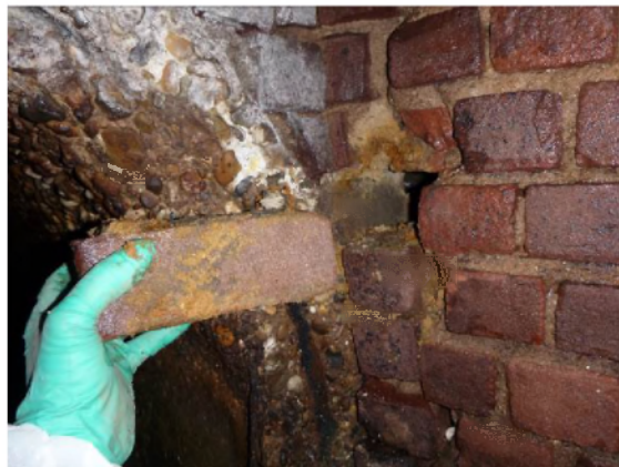
D: Losse steen in het metselwerk op putwand 2
