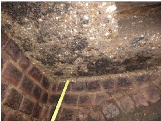
C: Resten van een zwarte coating zichtbaar op de dekplaat
