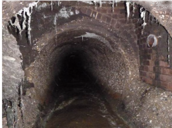
B: Blick in de put vanuit het hoofdriool met duidelijk zichtbare wortelingroei
