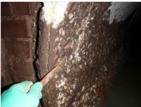
E: Het betonnen hoofdriool is gecorrodeerd en zacht
