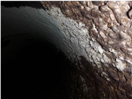
C: Sterk aangetast beton in het hoofdriool, brokken vallen er uit
