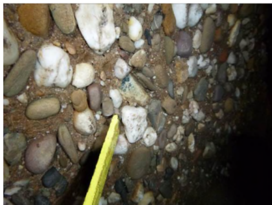
F: Sterk gecorrodeerd hoofdriool. Toeslagstoffen makkelijk te verwijderen
