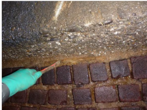
D: De mortel tussen dekplaat en metselwerk is niet sulfaatbestendig. Het is gecorrodeerd en zacht
