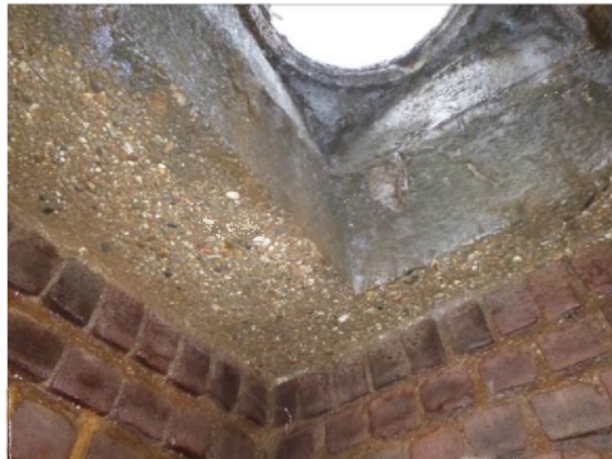
D: De betonnen dekplaat is matig aangetast en lijkt ooit vernieuwd te zijn
