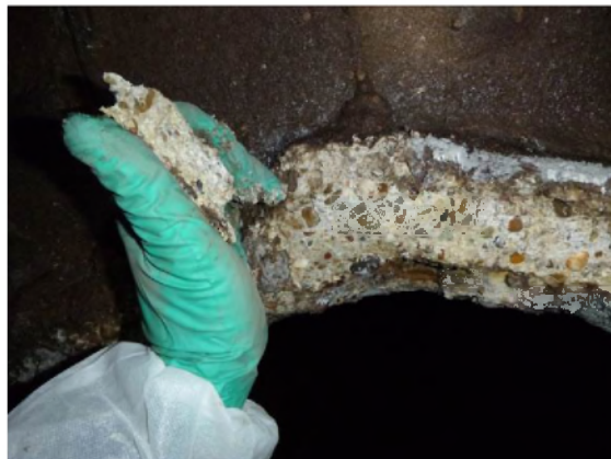
D: Zeer sterk gecorrodeerd beton in het hoofdpijool. Brokken beton zijn handmatig weg te nemen
