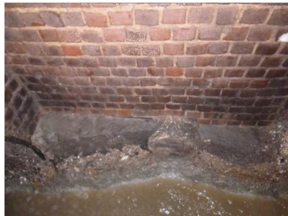
D: Dichtgemetseld inkomend riool op putwand 2
