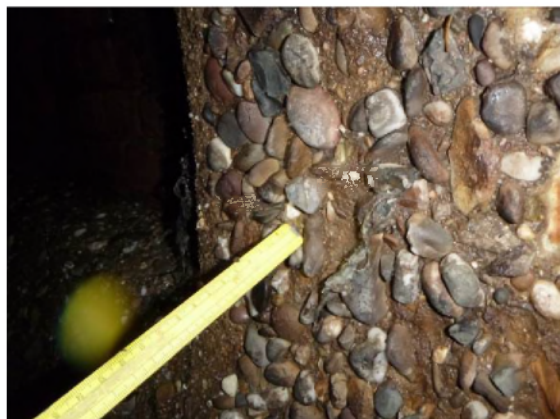
F: Detail sterk gecorrodeerd hoofdriool
