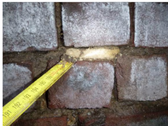
F: Sterk gecorrodeerde voegen
