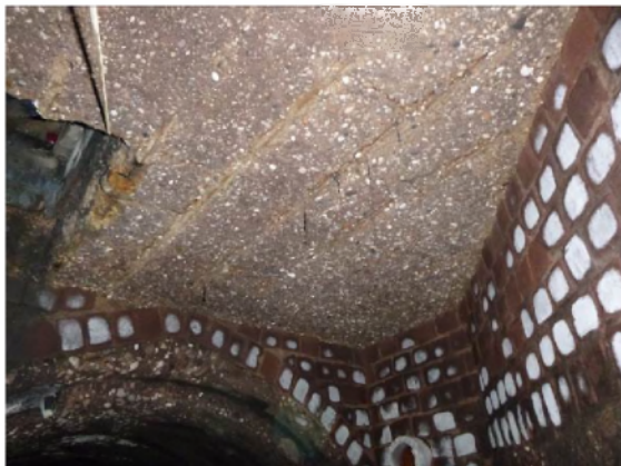
C: De betonnen dekplaat bij de putopening vertoont zichtbaar gecorrodeerde wapening
