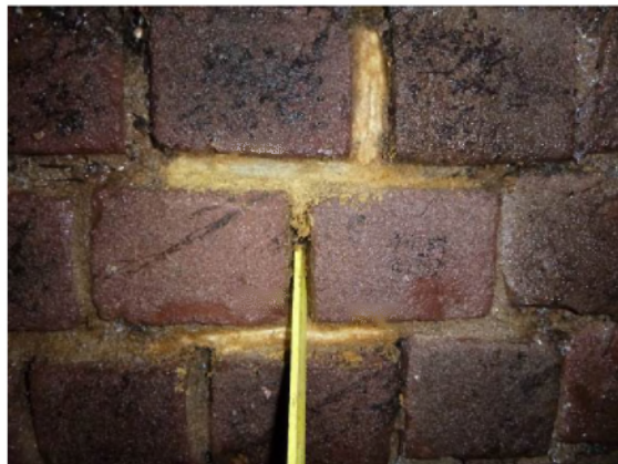
D: Voegen van het metselwerk zacht en gecorrodeerd
