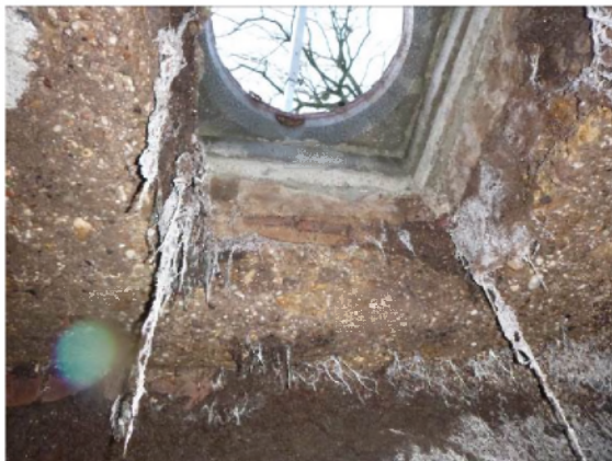
C: Blick vanuit de put naar boven met zicht op de sterk gecorrodeerde betonnen dekplaat en wortelingroei
