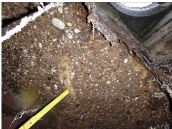
E: Detail ster gecorrodeerde dekplaat
