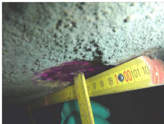
F: Er kon gemeten worden dat 8 mm beton door corrosie was verdwenen
