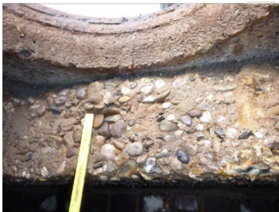
H: De vermoedelijk vernieuwde en sterk gecorrodeerde dekplaat
