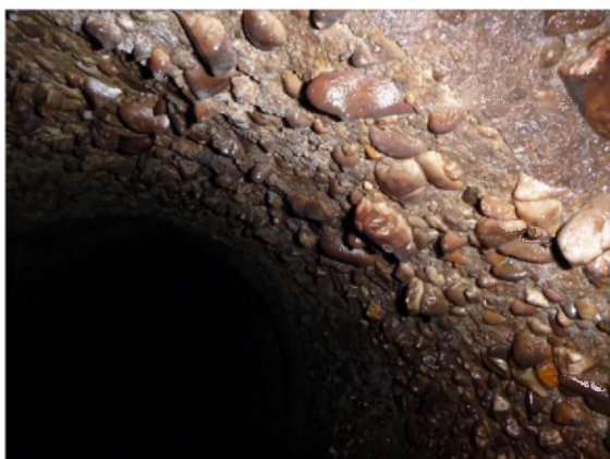
E: Sterke betonaantasting van het hoofdriool
