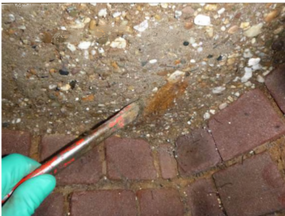
C: Gecorrodeerde wapening in de dekplaat zichtbaar
