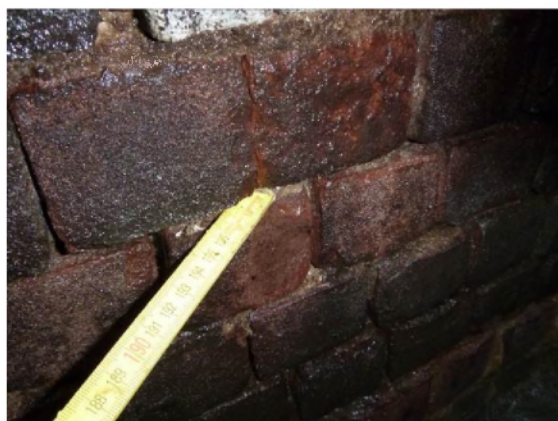
F: Sterk gecorrodeerde voegen tot een diepte van 4 cm
