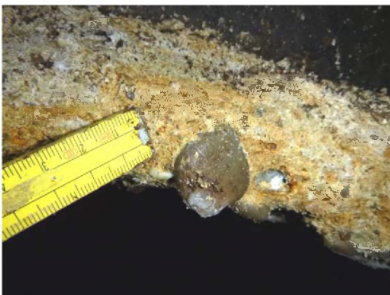
E: Detail van biogene zwavelzuurcorrosie. Kiezels zijn uitgevallen en deze ook bijna
