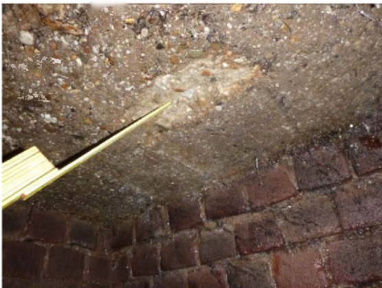
C: Gecorrodeerde onderzijde van de dekplaat
