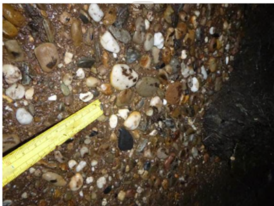
E: Detail van het sterk gecorrodeerde hoofdriool
