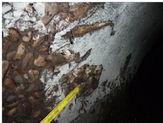
D: Detail van het sterk gecorrodeerde hoofdriool met uitvallende toeslagstoffen
