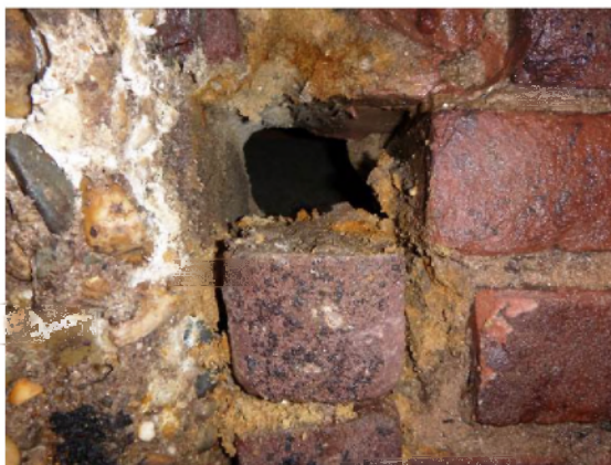
J: Los zittende stenen in het metselwerk op putwand 2
