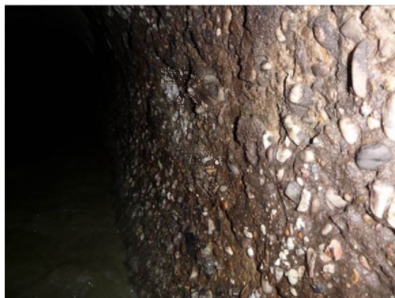
F: Detail van het sterk gecorrodeerde beton in het hoofdriool
