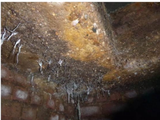
E: Bruine aftekening, door corrosie van de wapening, zichtbaar op dekplaat.
