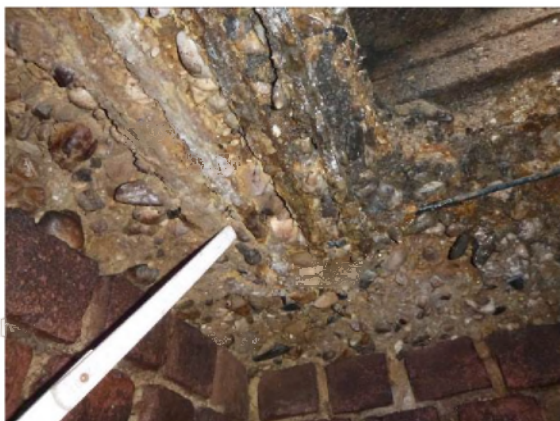
C: Blick vanuit de put op de aangetaste betonnen dekplaat
