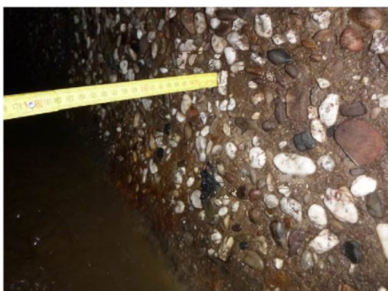
E: Detail van de wand van het sterk gecorrodeerde hoofdriool met uitvallende toeslagstoffen
