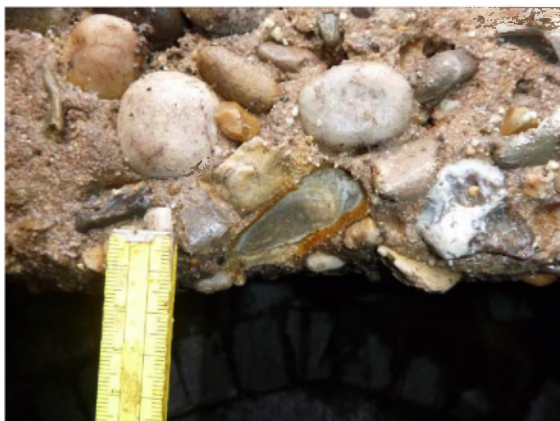
I: Detail van de sterk gecorrodeerde dekplaat met uitvallende kiezels
