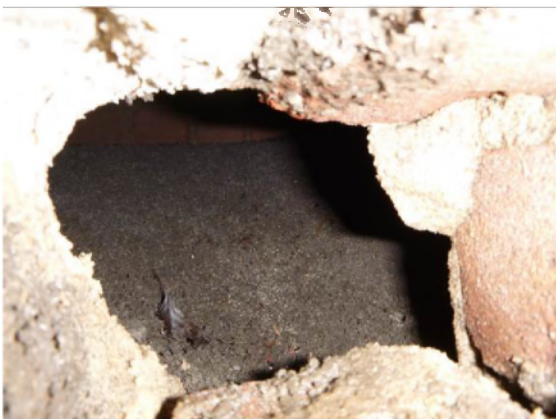
E: Grond en holle ruimte zichtbaar door het gat van de verwijderde steen. 50 cm verder is nog een gemetselde muur zichtbaar
