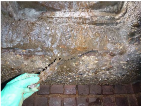
C: Wapening is uit het beton los te trekken
