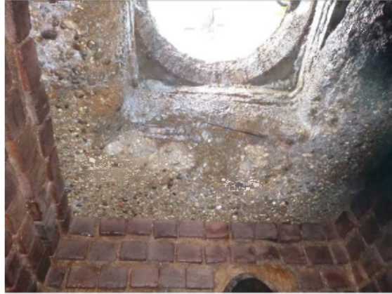
B: Blik vanuit de put naar boven. Sterk ge-corrodeerde dekplaat en ge-corrodeerde wape-ning zichtbaar
