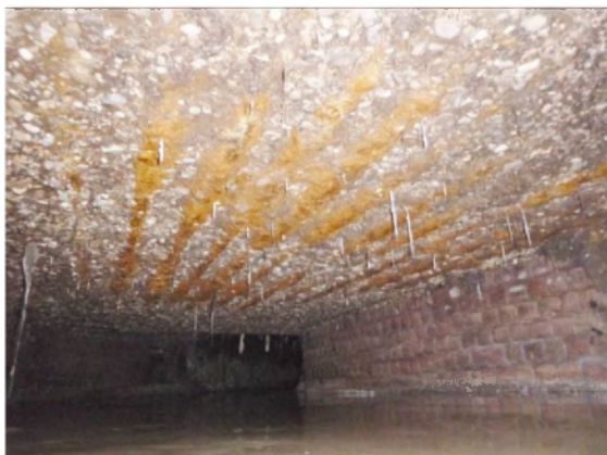
E: De betonnen dekplaat ter plaatse van de overkluizing vertoont gecorrodeerde wapening.
