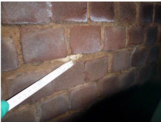
C: Gecorrodeerde zachte voegen
