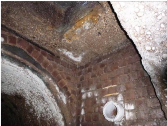
C: Inkomend riool op putwand 2, gecorrodeerde wapening in de dekplaat
