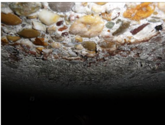
E: Detail van betoncorrosie op de dekplaat
