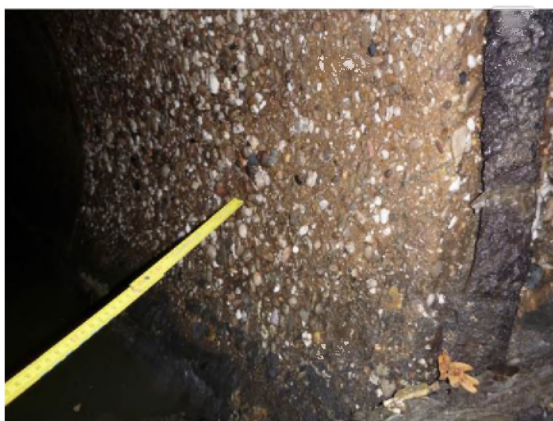
F: Matig gecorrodeerd hoofdriool
