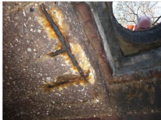
D: Detail van de gecorrodeerde wapening
