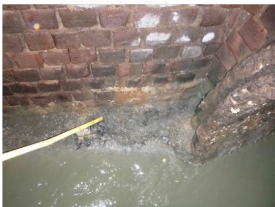
E: Grondwaterinfiltratie bij de voegen op putwand 4 (tevens geconstateerd op wand 2)
