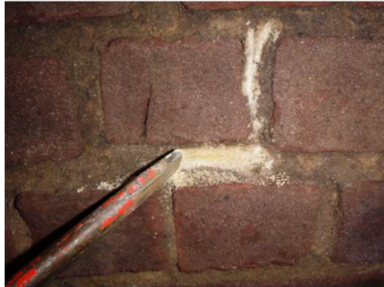
B: De voegen van het metselwerk waren zacht en gecorrodeerd
