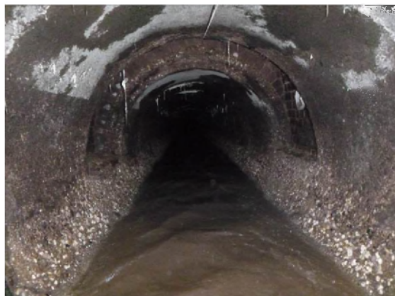
F: Restanten van een zwarte coating zichtbaar in het hoofdriool
