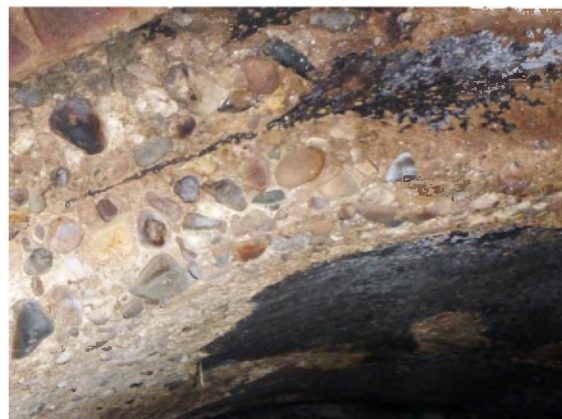
F: Detail van de restanten van zwarte coating in het hoofdriool
