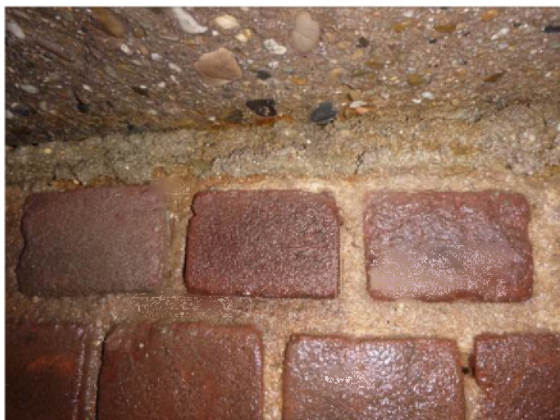
G: Kleurverschil bij de aansluiting met de dekplaat duidt op vernieuwing van de dekplaat
