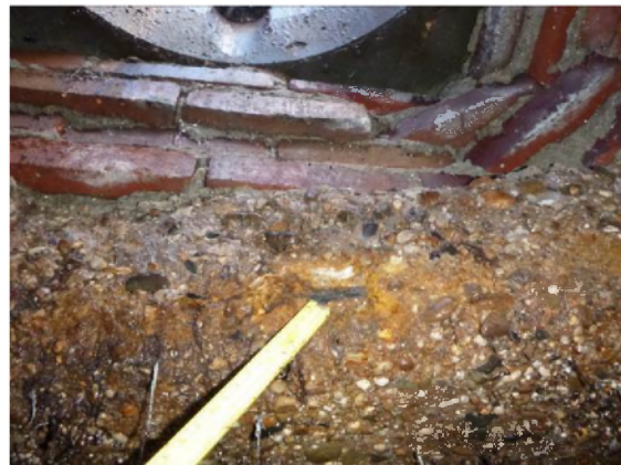
D: Gecorrodeerde wapening zichtbaar in de dekplaat
