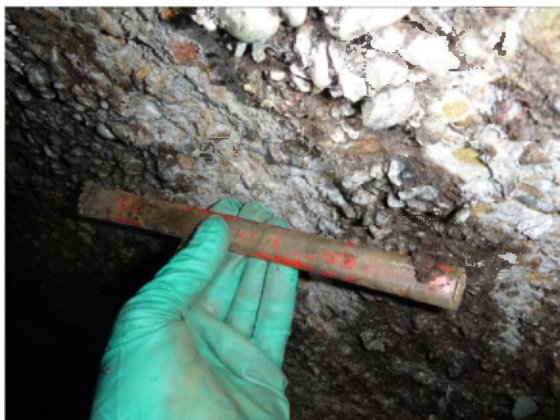
G: Detail van het sterk gecorrodeerde hoofdriool. Het beton is met de vingers weg te schrapen
