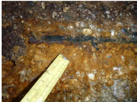
D: Detail van de gecorrodeerde wapening in de dekplaat
