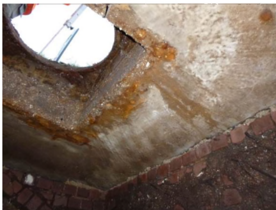
D: Blik naar boven, op de dekplaat met bruine aftekening door corrosie van wapening
