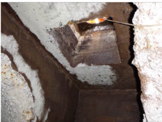
E: De dekplaat vertoont lichte tot matige corrosie
