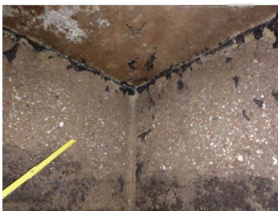
F: Blik op de licht aangetaste betonnen putwanden en dekplaat
