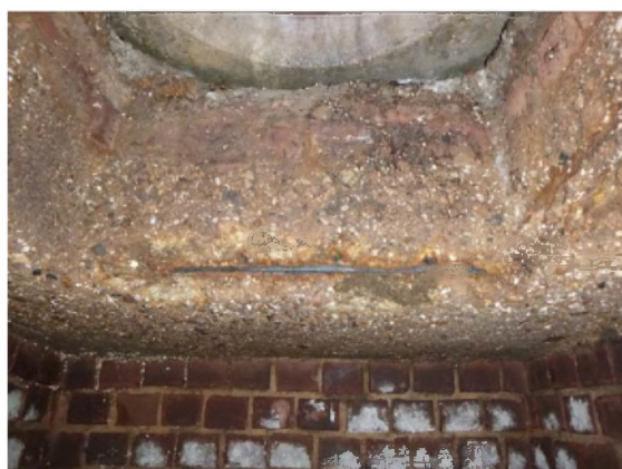
F: Vrij liggende gecorrodeerde wapening in de dekplaat
