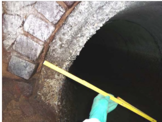
D: De plaats in het hoofdriool waar het beton het sterkst gecorrodeerd is (9-10 uur)
