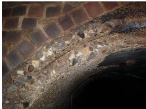
D: Detail van het gecorrodeerde betonnen hoofdriool met rechts in beeld nog resten zichtbaar van een zwarte coating
