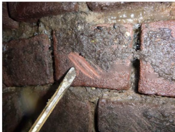
D: Oppervlakkig gecorrodeerde stenen en gecorrodeerde voegen
