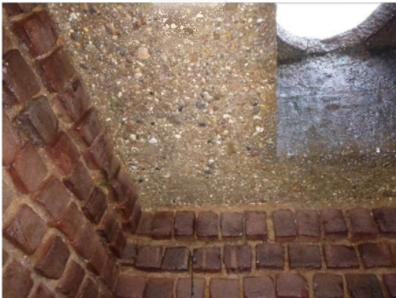
C: De dekplaat van de put is licht gecorrodeerd en lijkt vernieuwd te zijn
