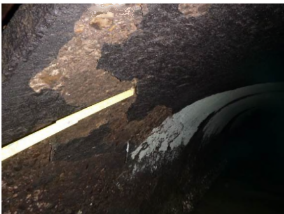
E: Detail van de wand van het hoofdriool met resten van een loslatende coating
