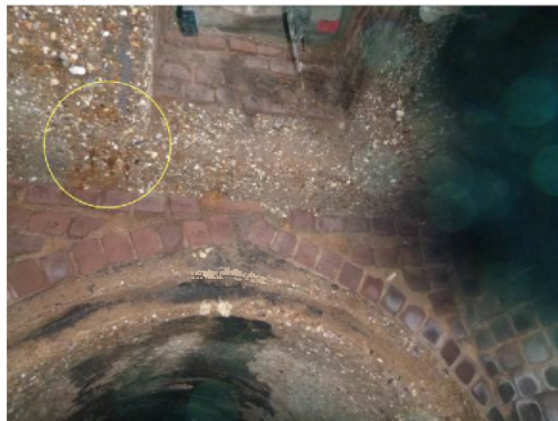
D: Gecorrodeerde wapening in de dekplaat zichtbaar (zie cirkel)
