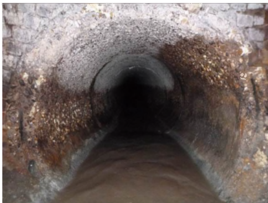
H: Blik vanuit de put in het sterk gecorrodeerde hoofdriool
