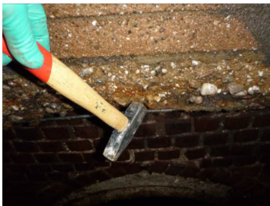
D: Het beton is gemakkelijk weg te kloppen
