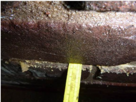
C: Sterk gecorrodeerde voegen, tot een diepte van 2,5 cm.
