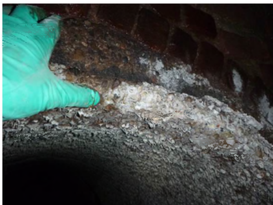
I: Detail van het sterk gecorrodeerde betonnen hoofdriool. Het beton brokkelt af
