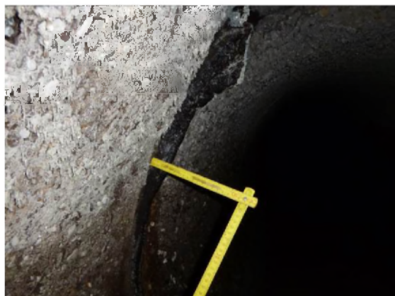
F: Van het hoofdpijool is 4 cm beton verdwenen door corrosie
