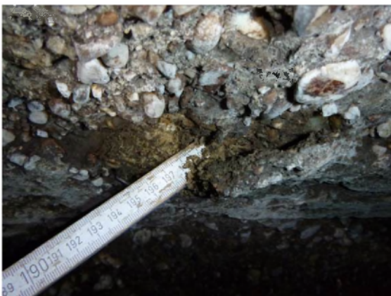
E: Gecorrodeerde delen beton in het hoofdriool gemakkelijk weg te steken met duimstok
