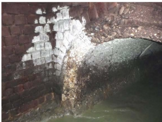
C: Sterk gecorrodeerd hoofdriool, vooral het gedeelte vanaf de waterlijn tot 11 uur
