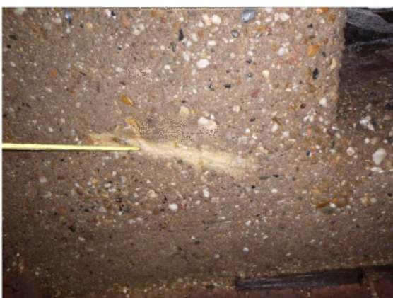
E: Onderzijde van de dekplaat. Gecorrodeerd en zacht
