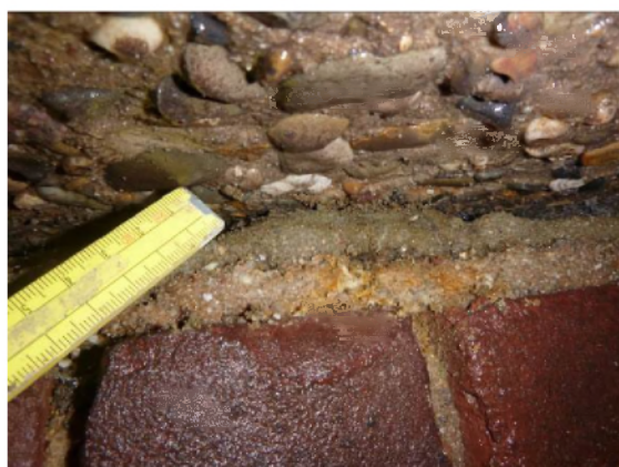
F: Kleurverschil in de voeg bij de aansluiting van de dekplaat op het metselwerk duidt op vernieuwing van de dekplaat
