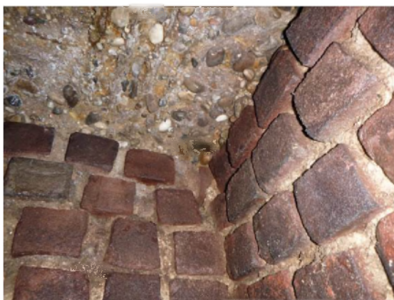
F: Voegen voor een groot deel weg gecorrodeerd
