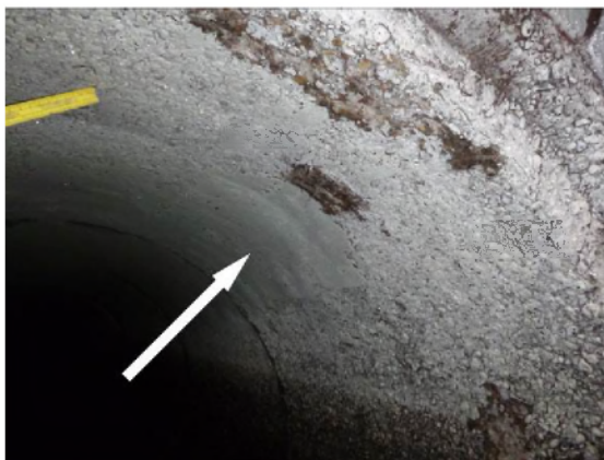
J: Overzicht van de sterk gecorrodeerde en wit uitgeslagen buiswand van het hoofdriool met delen van een oude coating zichtbaar (zie witte pijl)
