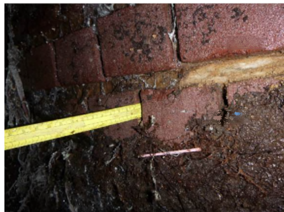
F: Zachte gecorrodeerde voegen
