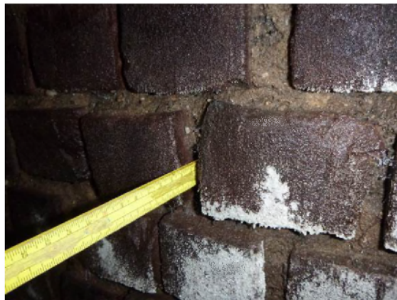
D: Voegen van het metselwerk zacht en ge-corrodeerd, op putwand 4 tot 4 cm diepte
