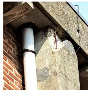
Afbeelding 4 - Schade kolom-spant verbinding
