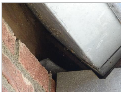
Foto 33: Openingen bij dakrand/dakgoot.
