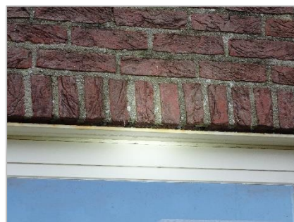
Foto 24: Openingen bij raamkozijn.
