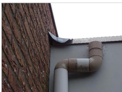
Foto 21: Openingen bij dakrand.
