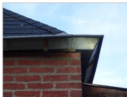
Foto 28: Openingen bij dakrand/dakgoot.
