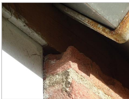
Foto 30: Openingen bij dakrand/dakgoot.
