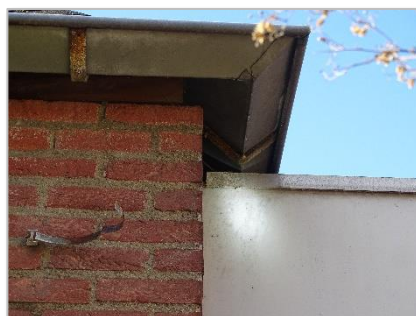
Foto 34: Openingen bij dakrand/dakgoot.
