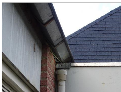
Foto 29: Openingen bij dakrand/dakgoot.
