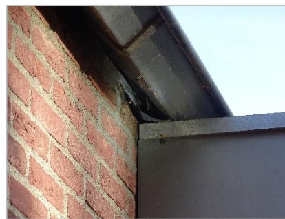
Foto 31: Openingen bij dakrand/dakgoot.
