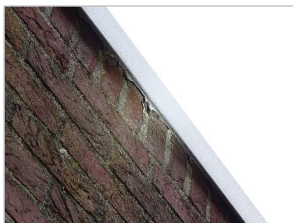
Foto 23: Openingen bij dakrand.
