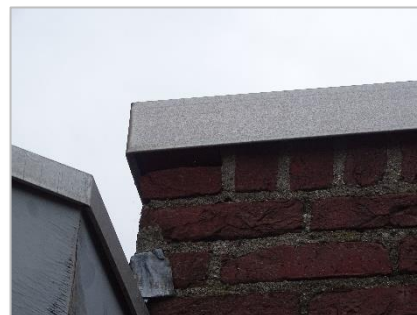
Foto 22: Openingen bij dakrand.
