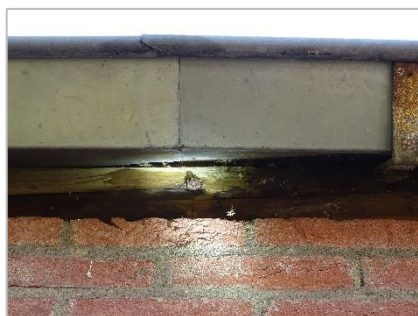
Foto 32: Openingen bij dakrand/dakgoot.
