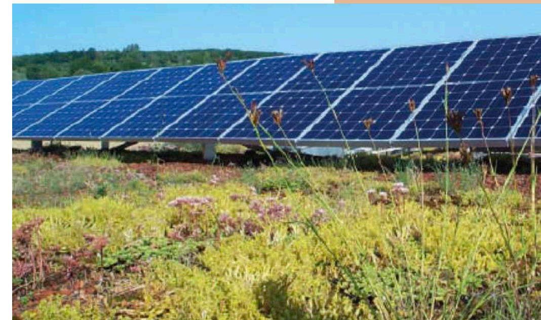
Combinatie van groen dak met zonnepanelen.
