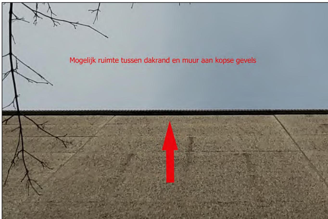
Kopgevels. Veel van de paaractiviteit concentreerde zich hier. De paarverblijven kunnen zitten in het dak maar ook in de gevel, aangezien het cement van de voegen op sommige plekken weg is, waardoor er een gat naar de spouw is ontstaan.
