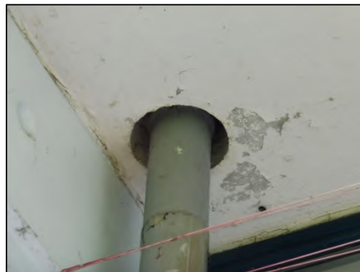
Foto 2: Regenpijp loopt door het balkon bij de flat, hierdoor ontstaat een opening waar vleermuizen in kunnen komen.
