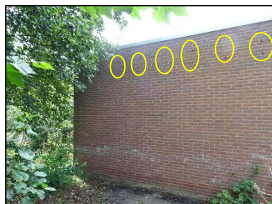
Figuur 13. Open stootvoegen aanwezig in de buitenmuur.
