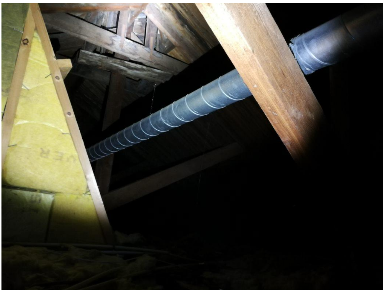
Figuur 3 Wateroverlast bij de balken op de zolders
