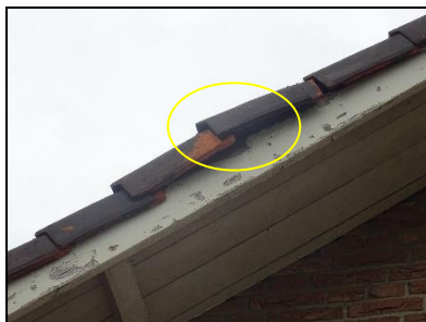
Figuur 9. Detailfoto van scheef liggende dakpan, waardoor een opening ontstaat onder de daklijst.
