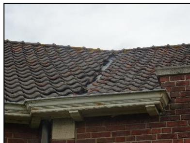
Figuur 10. Detailfoto van opengebroken rij met dakpannen, gelegen direct boven de hoofdingang van de bebouwing.
