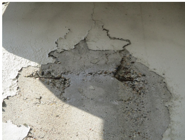
Figuur 8.6: Afgedrukt en losliggend beton met wapeningscorrosie, detail binnenzijde wand A.
