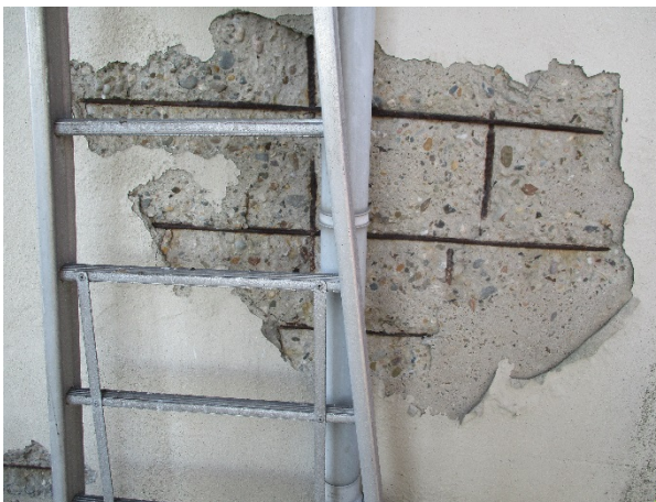
Figuur 8.3: Afgedrukt en losliggend beton met wapeningscorrosie, binnenzijde wand A.
