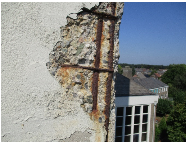
Figuur 8.9: Afgedrukt en losliggend beton met wapeningscorrosie, buitenzijde wand C.
