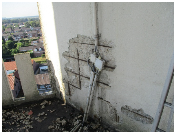
Figuur 8.4: Afgedrukt en losliggend beton met wapeningscorrosie, binnenzijde wand A.
