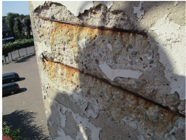
Figuur 8.8: Afgedrukt en losliggend beton met wapeningscorrosie, buitenzijde wand C.
