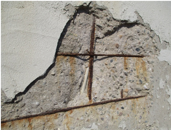
Figuur 8.7: Afgedrukt en losliggend beton met wapeningscorrosie, buitenzijde wand C.
