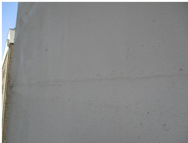
Figuur 8.18: Horizontale scheur t.p.v. stortnaad binnenzijde wand E.
