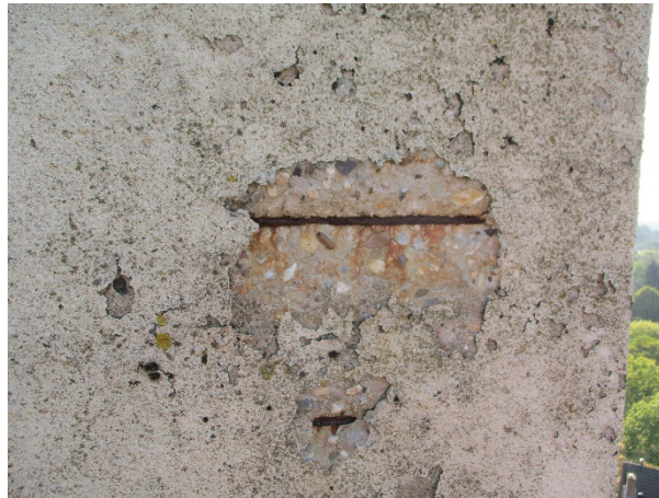
Figuur 8.2: Afgedrukt en losliggend beton met wapeningscorrosie, buitenzijde wand A.
