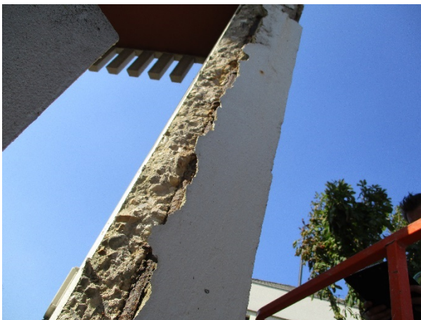
Figuur 8.15: Afgedrukt en losliggend beton met wapeningscorrosie, buitenzijde wand E.
