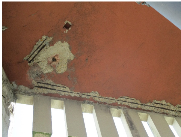
Figuur 8.22: Afgedrukt en losliggend beton met wapeningscorrosie, onderzijde dak.
