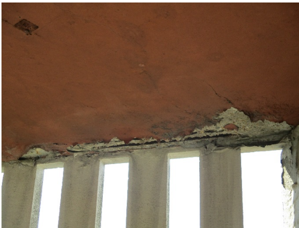
Figuur 8.21: Afgedrukt en losliggend beton met wapeningscorrosie, onderzijde vloer 6 e verdieping.
