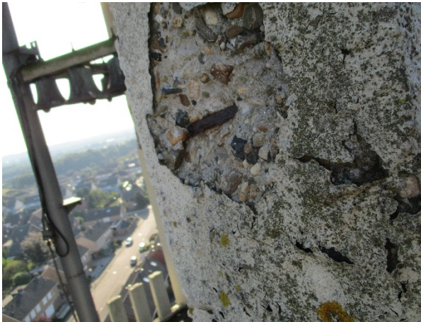
Figuur 8.1: Afgedrukt en losliggend beton met wapeningscorrosie, buitenzijde wand A.
