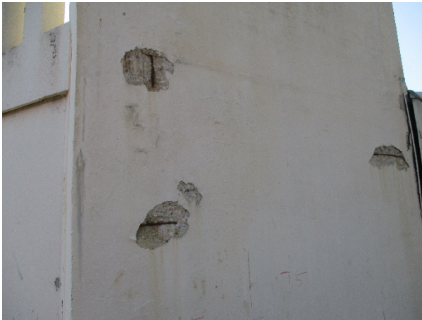
Figuur 8.13: Afgedrukt en losliggend beton met wapeningscorrosie, buitenzijde wand E.
