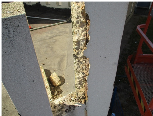
Figuur 8.16: Afgedrukt en losliggend beton met wapeningscorrosie, buitenzijde wand E.
