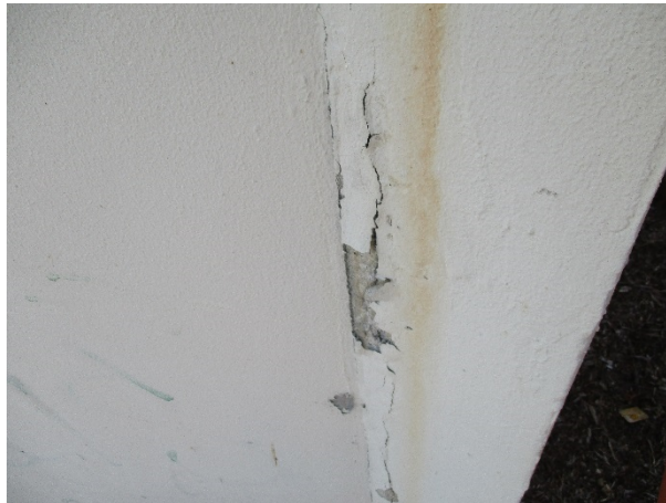
Figuur 8.14: Afgedrukt en losliggend beton met wapeningscorrosie, buitenzijde wand E.
